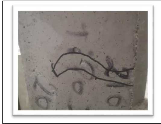
Foto 42: Evidencia de Falla en Viga - Concreto Tipo I con adición de 20 kg de Fibra de Acero
