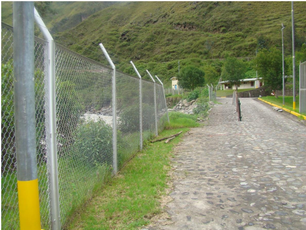
Figura 70: Fotografía vista con parte del camino erosionado
