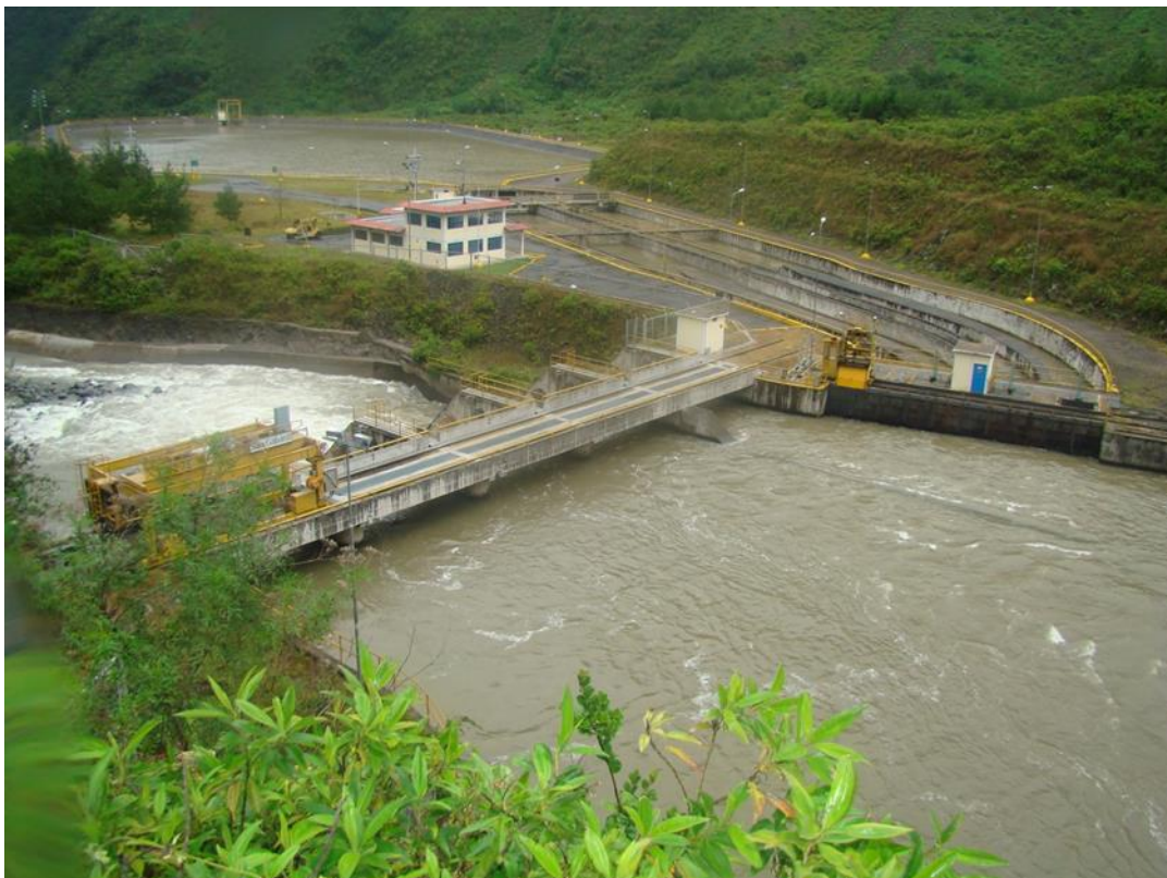
Figura 68: Fotografía Barraje móvil aguas arriba del lugar de socavación
