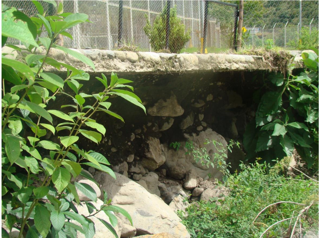
Figura 71: Fotografía vista mostrando la zona erosionada
