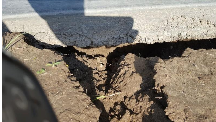
Figura 41: Asentamiento de suelos
