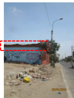
Figura 25 . Edificación en mal estado Se aprecia que las áreas destinadas a teatro y baile se realiza al aire libre
