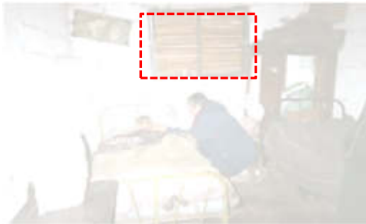
Figura 11. CAUSA 1.1 En la foto se puede observar que un mismo dormitorio se encuentran mas de 2 camas, y que el espacio no cumple con el RNE y la ventilación esta clausurada con madera
