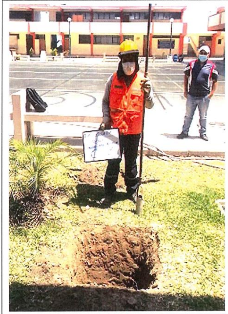
Foto N°01: Vista de la calicata C-01, de 0.00 a 0.45m presencia de arena limosa con raíces y afirmado. De 0.45m a 3.00m presencia de arena mal graduada (SP), medianamente compacto a muy compacto, ligeramente húmedo de color beige. No se registró la presencia del nivel freático.
