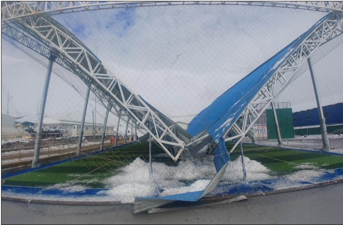
Figura 5. Falla por colapso de estructura, Minera Bateas, Caylloma, enero 2019.
