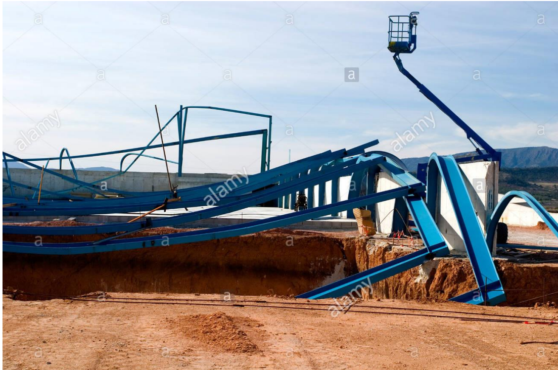
Figura 2. Colapso por fuertes vientos.
