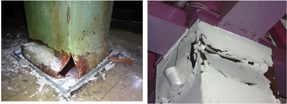
Figura 1. Falla por aplastamiento ocurrido por un sismo en Mexico 7 septiembre de 2017.
