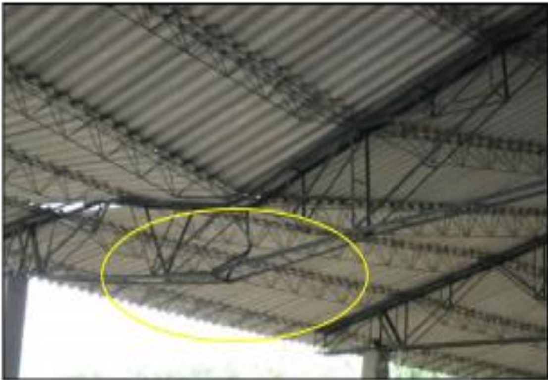
Figura 4. Falla en armadura de techi por pandeo a compresión, fuente San Salvador 2012
