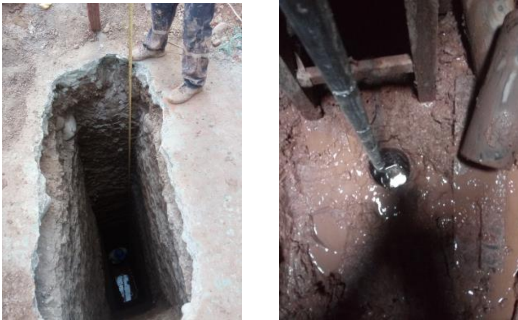
Figura N° 50: Agua en fondo de calicata y agua en perforación.
