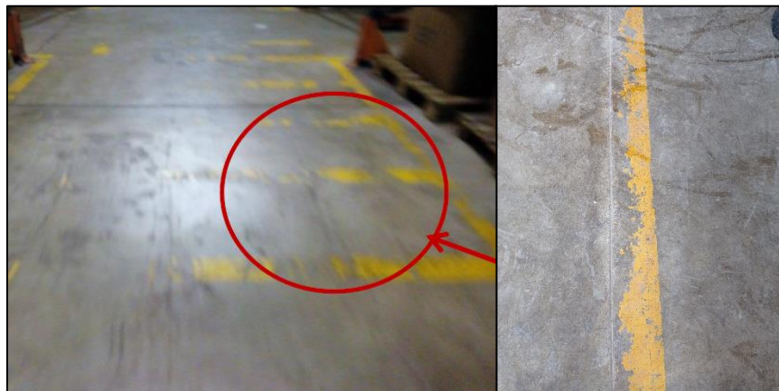
Figura 26. Señalización defectuosa, Sinba.
