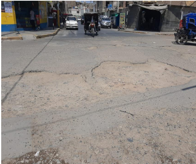
Ilustración 04: desgaste por piel de cocodrilo, baches, desprendimiento con hundimiento, etc.
