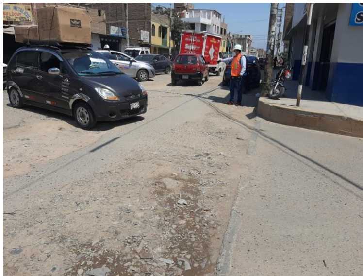
Ilustración 06: presencia de desprendimiento con hundimiento
