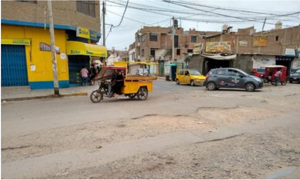
CDRA 6, Entre la Av. Pedro Ruiz y el pasaje Balarezo Falla N° 15 (estructural, presenta hundimiento) Bache
