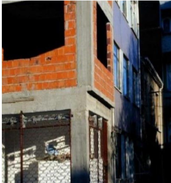
Figura 4 Discontinuidad de columna
