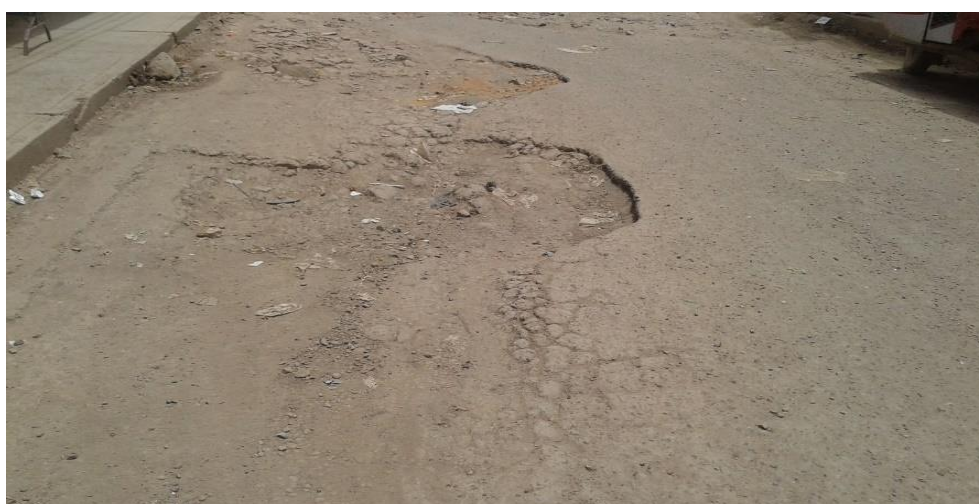
Figura 5: Vía en mal estado en Juliaca.
