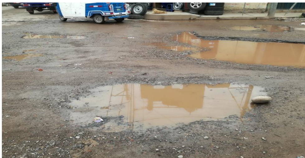
Figura 4: Vía deteriorada en el centro de la ciudad de Juliaca.
