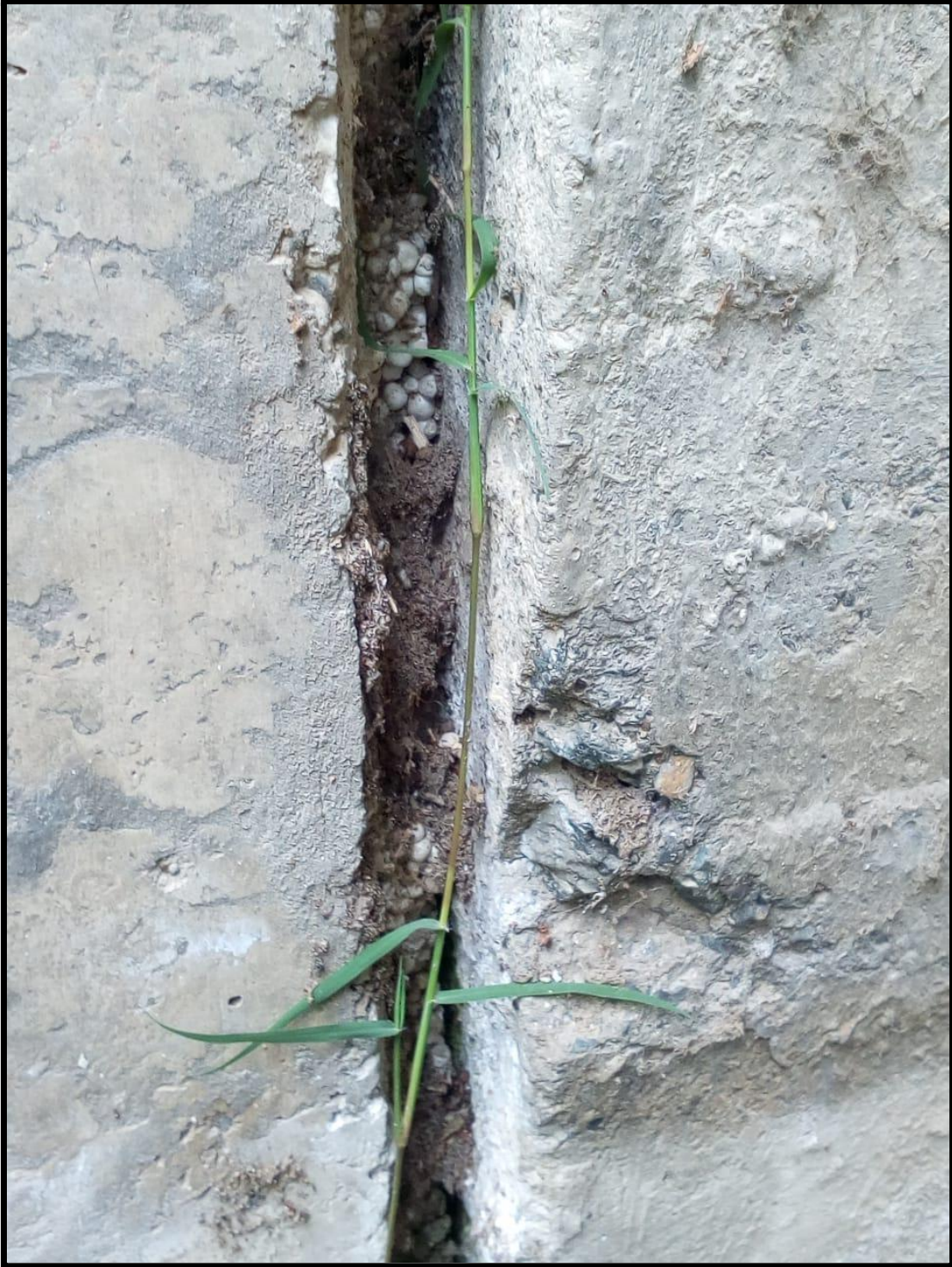
Se pudo observar también, como la materia orgánica está invadiendo las juntas de dilatación sísmica
