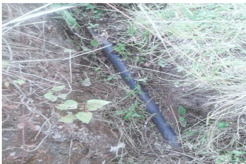
Figura 5: Línea de aducción existente
