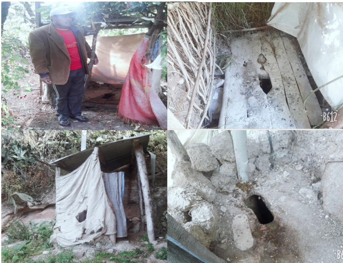
Figura 9: Letrina existente con material rústico
