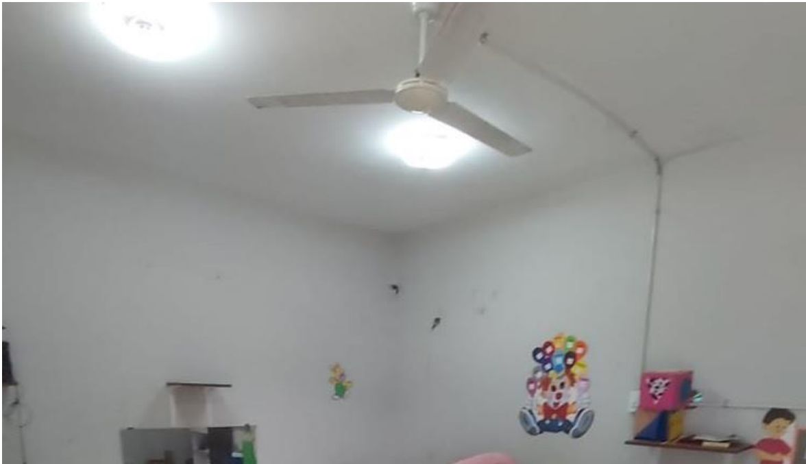
Figura 3: Déficit de iluminación natural en la sala multisensorial del CEBE-Nazareno
