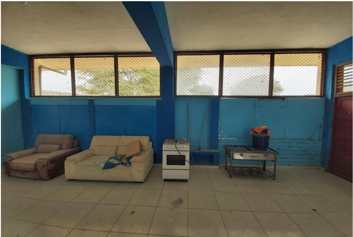
Figura 8: Infraestructura parametrizada, materialidad inadecuada en piso y paredes, inapropiado mobiliario para las personas con discapacidad y déficit de recursos de interacción y estimulación.
