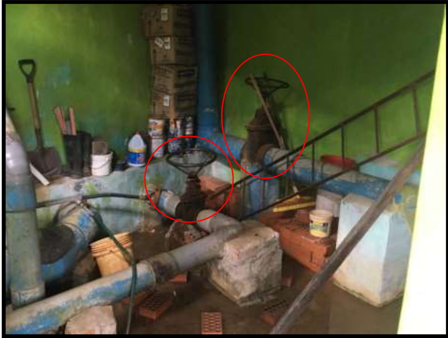
FOTOGRAFÍA N°17 VÁLVULAS DE INGRESO Y SALIDA DETERIORADAS POR EL PASO DEL TIEMPO
