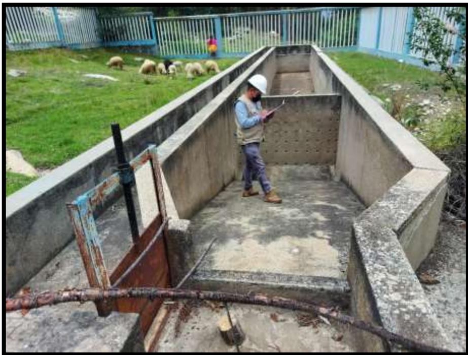
FOTOGRAFÍA N°12 DESARENADOR EN ESTADO INOPERATIVO
