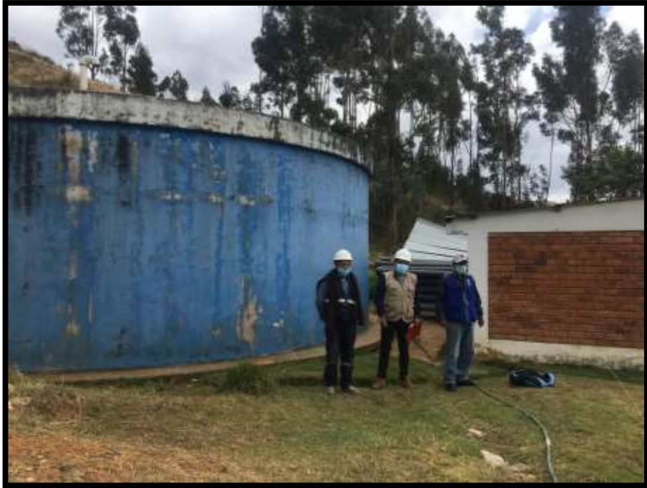
FOTOGRAFÍA N°15 RESERVORIO DEL SISTEMA DE AGUA POTABLE JAAPSHAN
