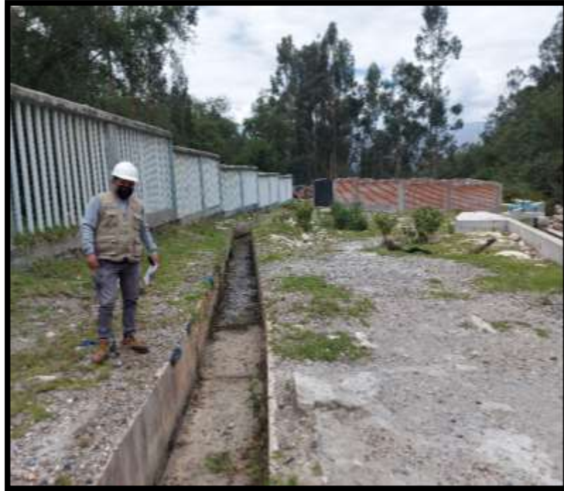
FOTOGRAFÍA N°09 CANAL DE CAPTACIÓN HACIA DESARENADOR INOPERATIVO
