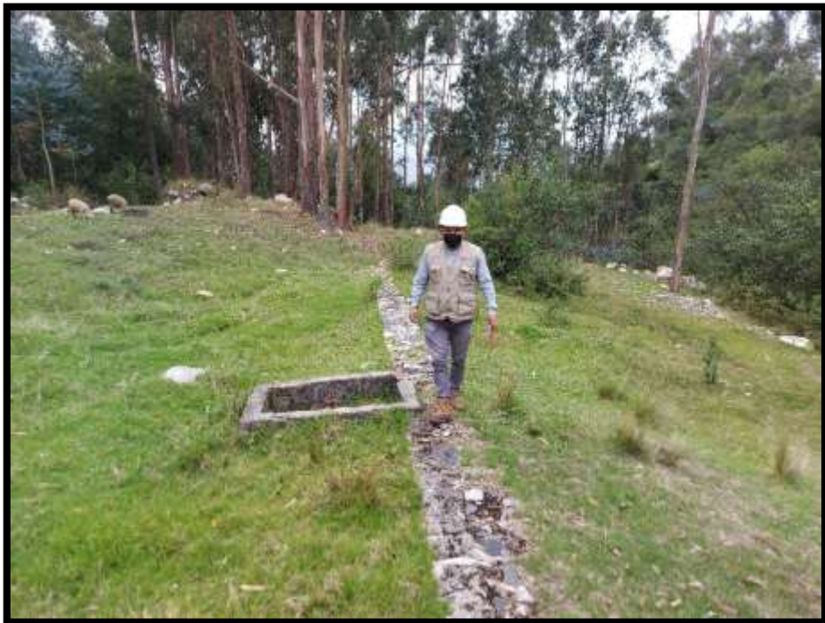
FOTOGRAFÍA N°14 LÍNEA DE ADUCCIÓN INOPERATIVO
