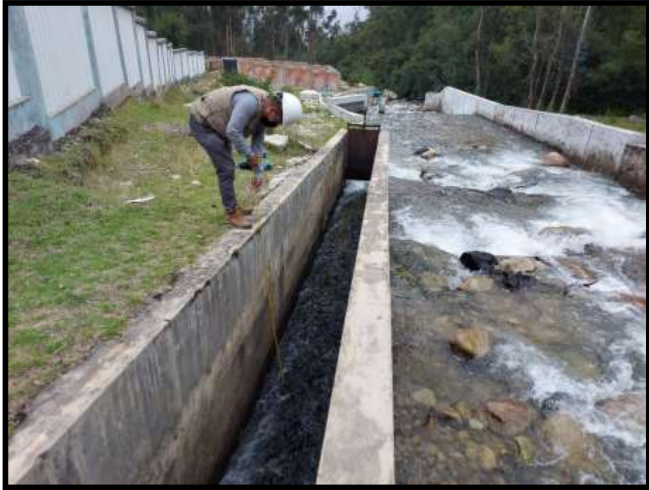
FOTOGRAFÍA N°05 MEDICIÓN DE LA ALTURA DE CANAL DE CAPTACIÓN PARA EL LLENADO EN FICHA TÉCNICA
