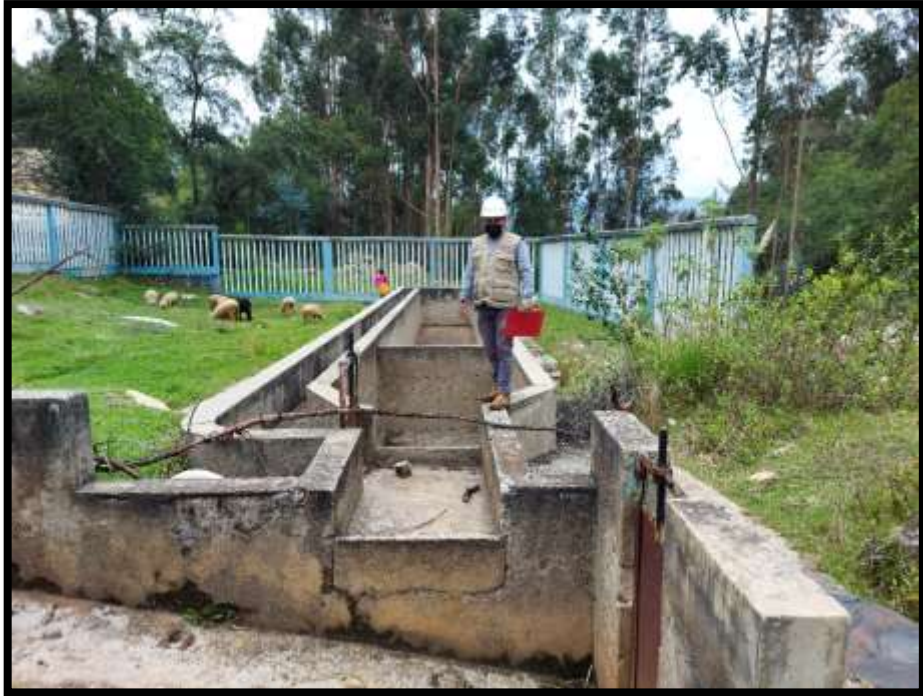
FOTOGRAFÍA N°11 INGRESO DEL DESARENADOR EN ESTADO DE ABANDONO
