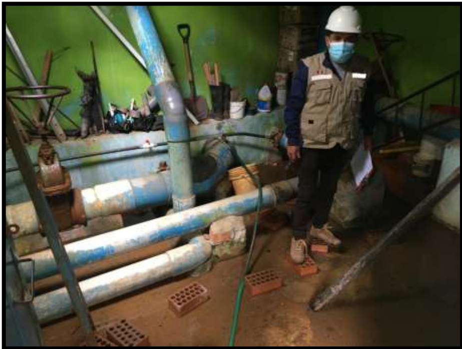
FOTOGRAFÍA N°18 TUBERÍAS DEL RESERVORIO, AGUA EMPOZADA POR LAS FILTRACIONES DE VÁLVULAS DAÑADAS
