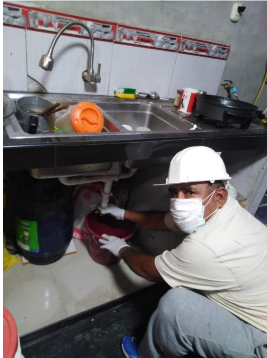
Fotografía 23. Método de recolección de agua del lavador de cocina, en todos los tres casos se afloja el registro de las trampas de 2" que están instalados en los diferentes accesorios – Vivienda 1 Santa Isabel #511.
