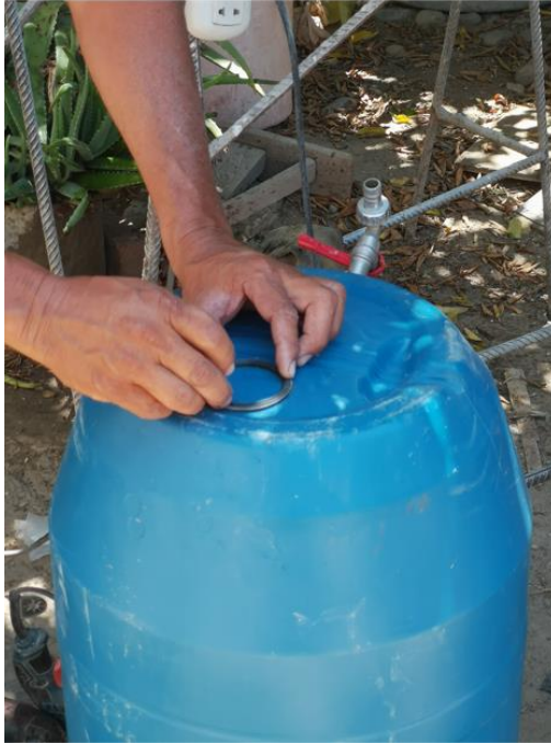
Fotografía 3. Realización del agujero en la parte inferior del cilindro. Agujero de 2" para tubería de rebose de agua excedente.
