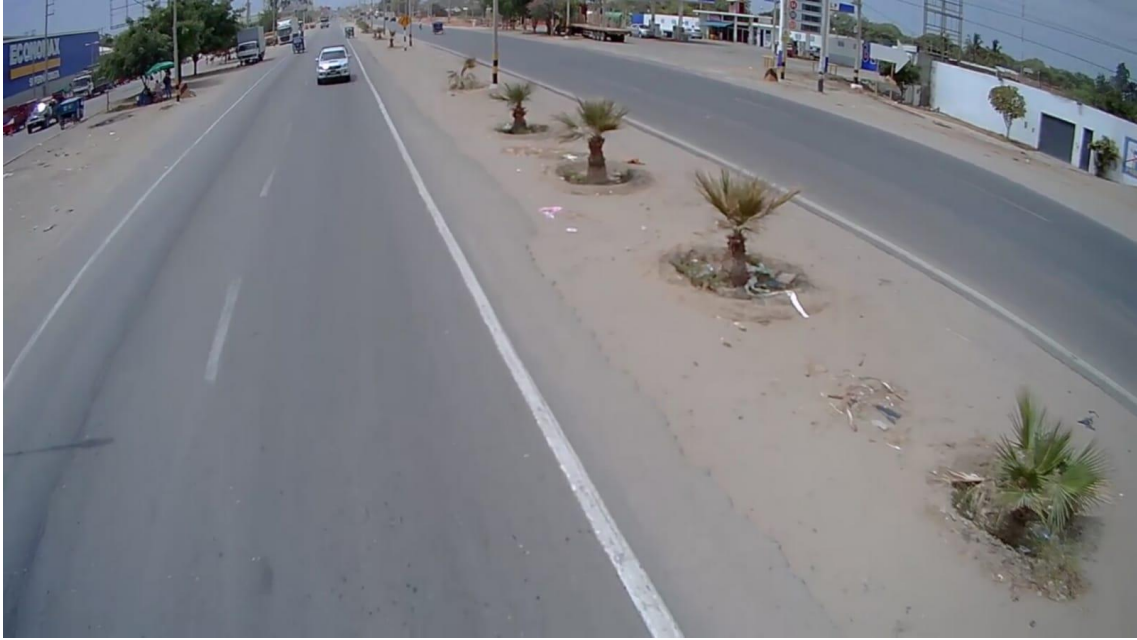
VISTA AEREA DE ENTRADA DE RAMAL PIURA – SULLANA NO CUENTA CON CURVAS DE APROXIMACION
