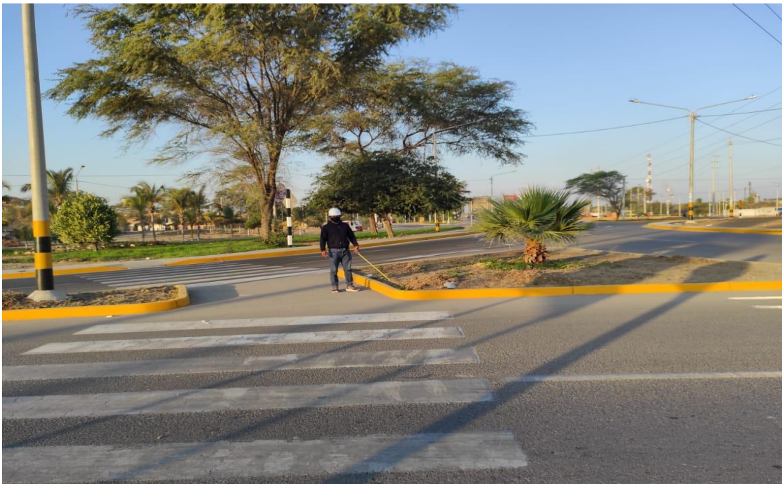
ISLILLA PARTIDORA EN RAMAL PIURA – SULLANA
