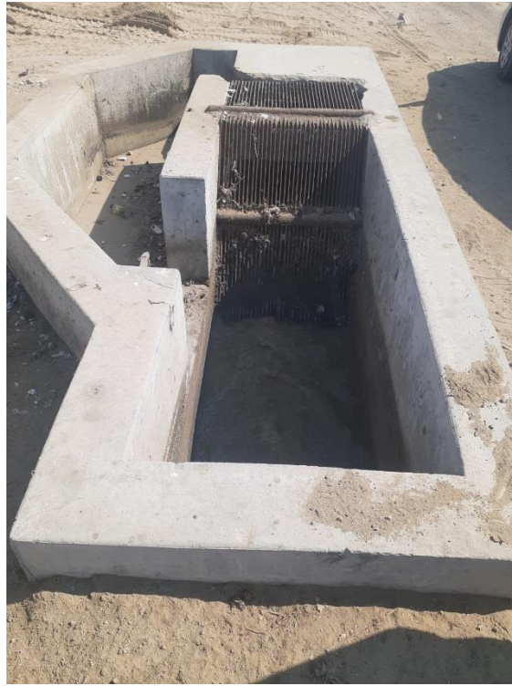
Imagen N°05: Cámara de rejas en mal estado observándose basura entre sus rejas
