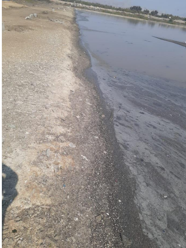
Imagen N°03: Se aprecia la falta de geomembrana en los bordes de la laguna.
