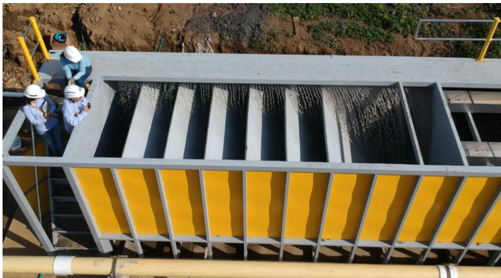
Figura 6. Planta potabilizadora de agua (Synertch 2021)
