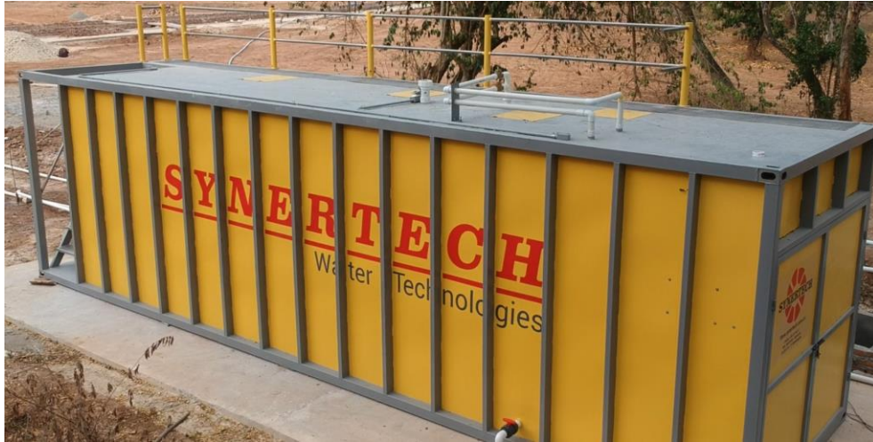
Figura 5. Planta potabilizadora de agua (Synertch 2021)
