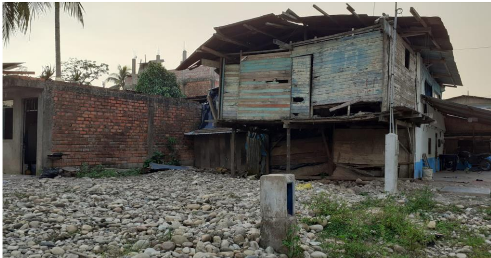
Figura 16. Vivienda de Madera en Deterioro
