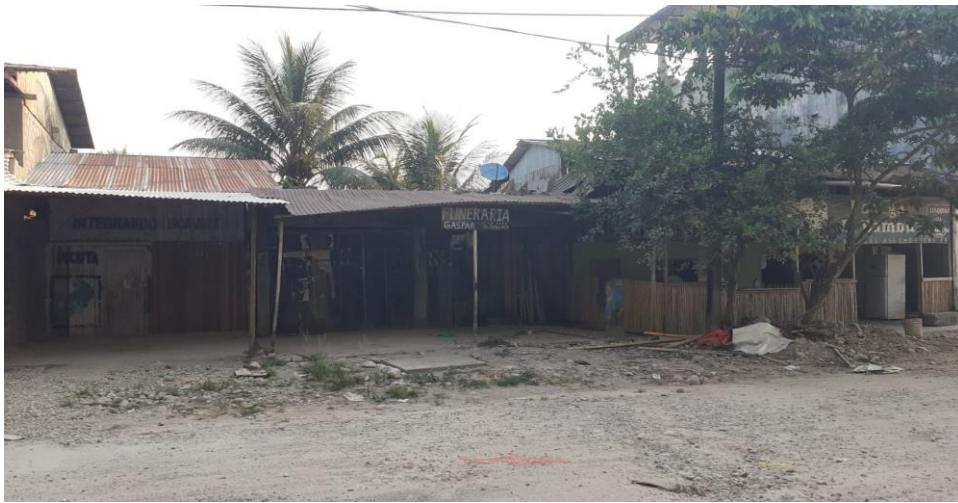
Figura 19. Viviendas en regular estado
