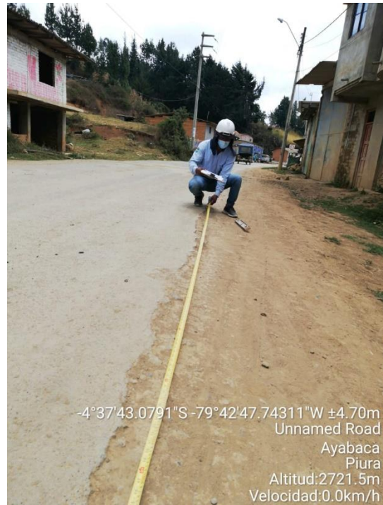
Figura 23: fisura de borde de severidad media
