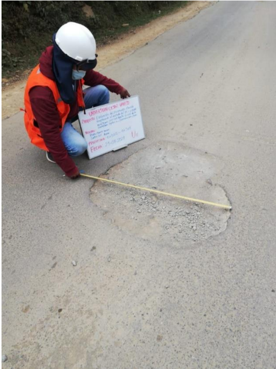
Figura 24: huecos con severidad media
