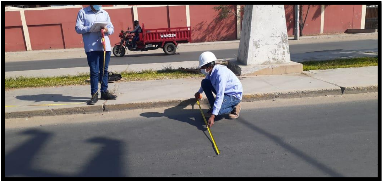
FOTO 03 Medición y clasificación de la falla encontrada en la superficie del pavimento
