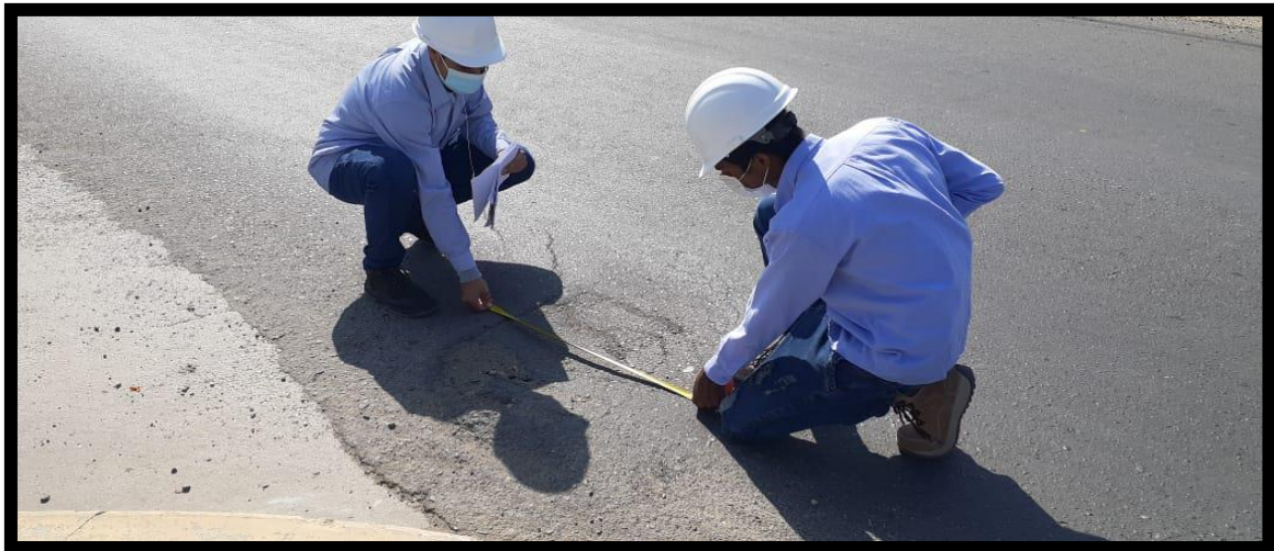
FOTO 01 Medición y clasificación de la falla encontrada en la superficie del pavimento
