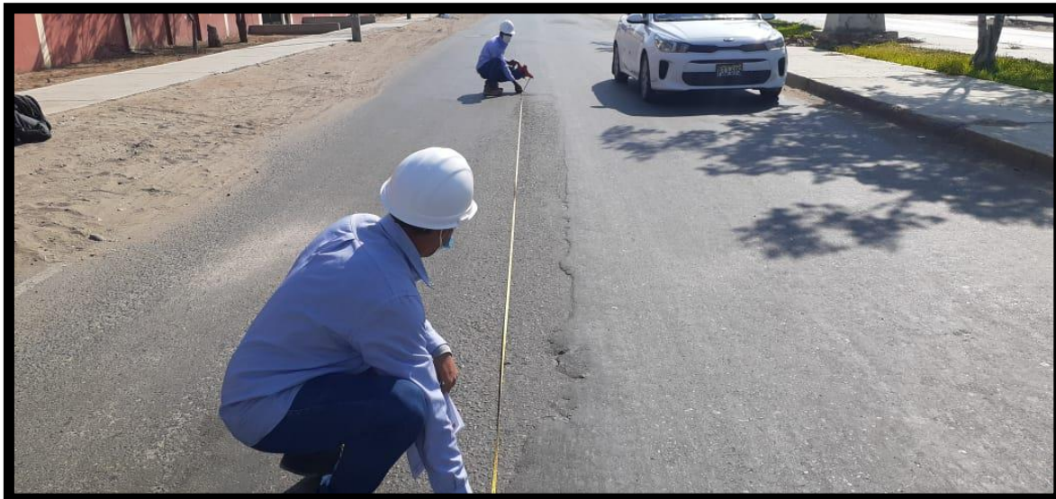
FOTO 08 Medición y clasificación de la falla encontrada en la superficie del pavimento
