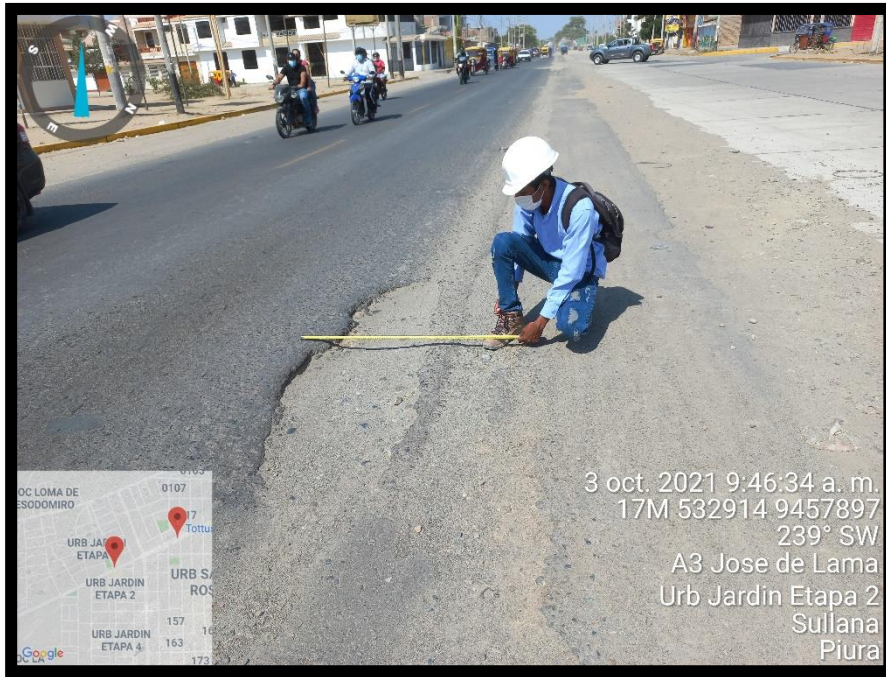
FOTO 14 Medición y clasificación de la falla encontrada en la superficie del pavimento
