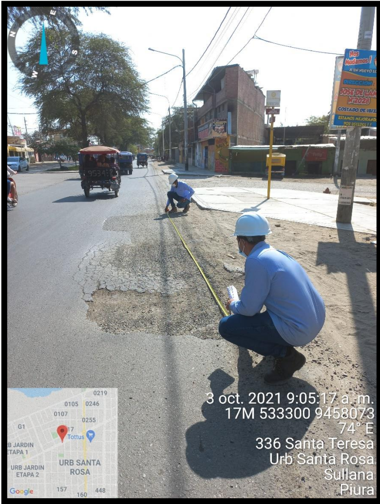
FOTO 10 Medición y clasificación de la falla encontrada en la superficie del pavimento
