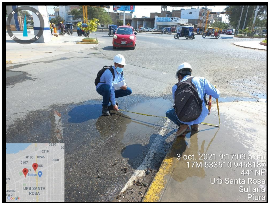
FOTO 13 Medición y clasificación de la falla encontrada en la superficie del pavimento
