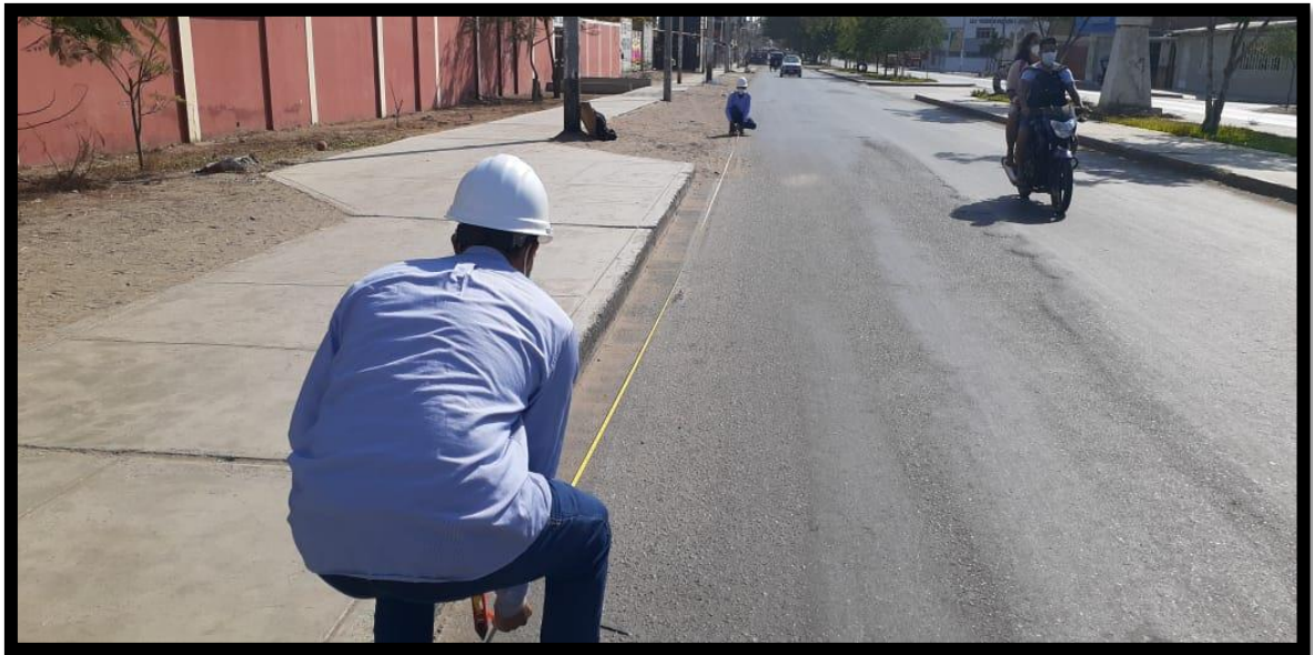
FOTO 09 Medición y clasificación de la falla encontrada en la superficie del pavimento
