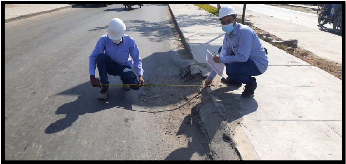
FOTO 05 Medición y clasificación de la falla encontrada en la superficie del pavimento
