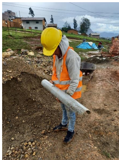
Figura N°129: Levantamiento de destino Post evaluación: Instalación Sanitaria 1
