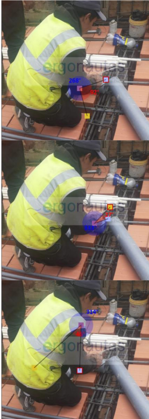
Figura N°37: Medición Grupo B: Instalación sanitaria 2.
