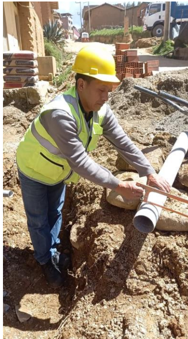
Figura N°131: Levantamiento de destino Post evaluación: Instalación Sanitaria 2
