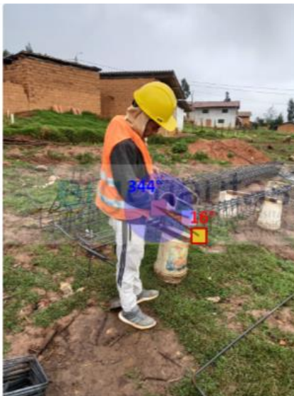
Figura N°96: Medición Grupo B: Instalación sanitaria 1.
