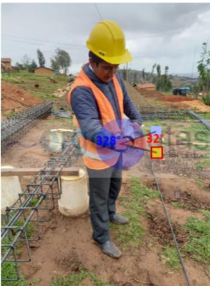
Figura N°99: Medición Grupo B: Instalación sanitaria 2
