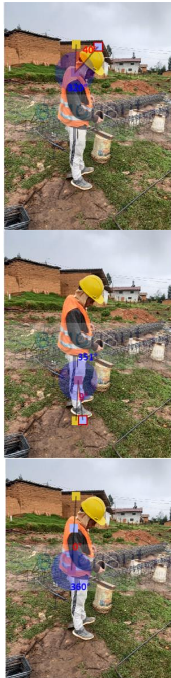
Figura N°95: Medición Grupo A: Instalación sanitaria 1.
