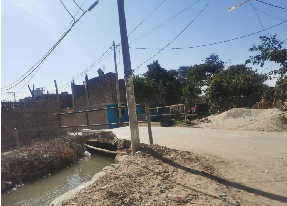
Fotografía 5. Zona crítica con riesgo de desborde
