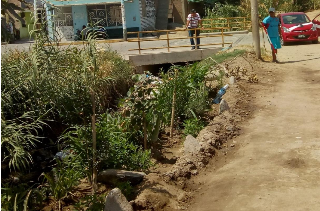
figura 54. Se aprecia abundante vegetación, acumulación de desperdicios y humedecimiento del suelo adyacente.
