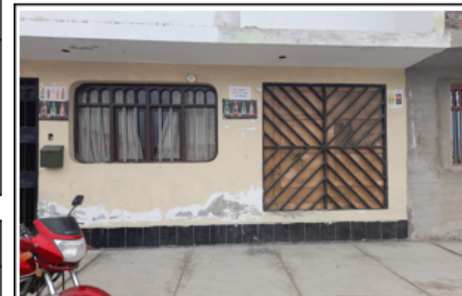
Imagen 3. Vista del mayor problema observado.
