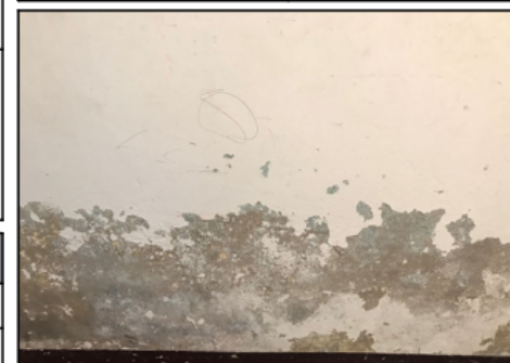
Imagen 3. Vista del mayor problema observado.
