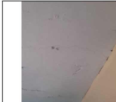
Imagen 3. Vista del mayor problema observado.
