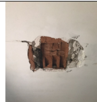
Imagen 3. Vista del mayor problema observado.
