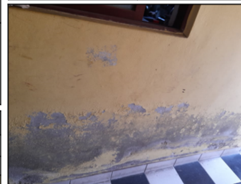
Imagen 3. Vista del mayor problema observado.
