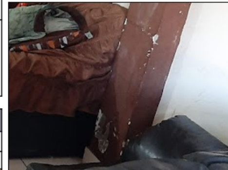
Imagen 3. Vista del mayor problema observado.
