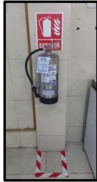
EXTINTOR TIPO K
