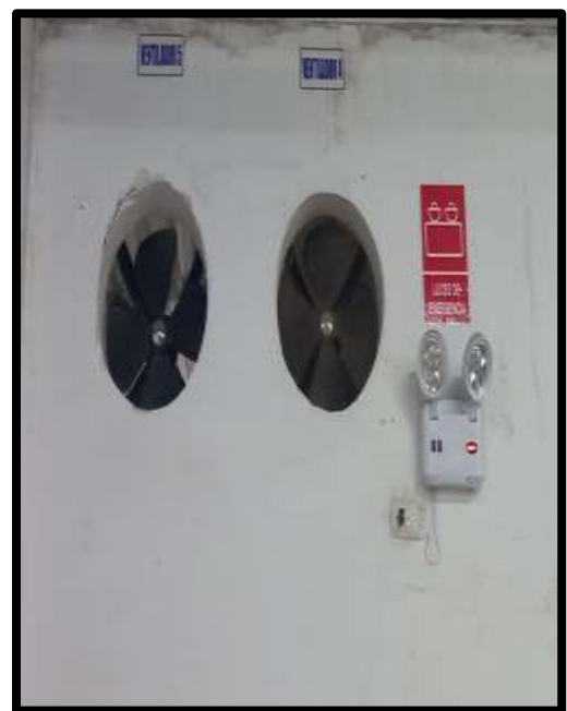
LUCES DE EMERGENCIA Y VENTILDORES
