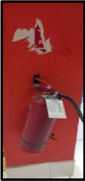
EXTINTOR PQS EN MAL ESTADO
