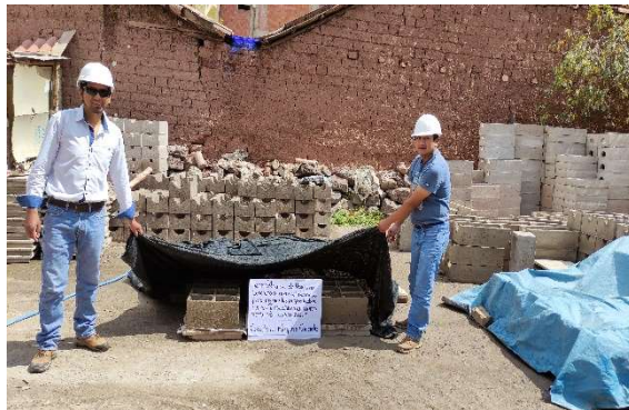
Foto. N° 23.- Zona de fraguado de los bloques de concreto para su respectivo curado.
