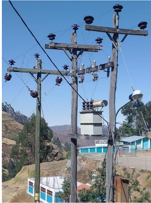
Figura 7: Postes de madera deterioradas.
