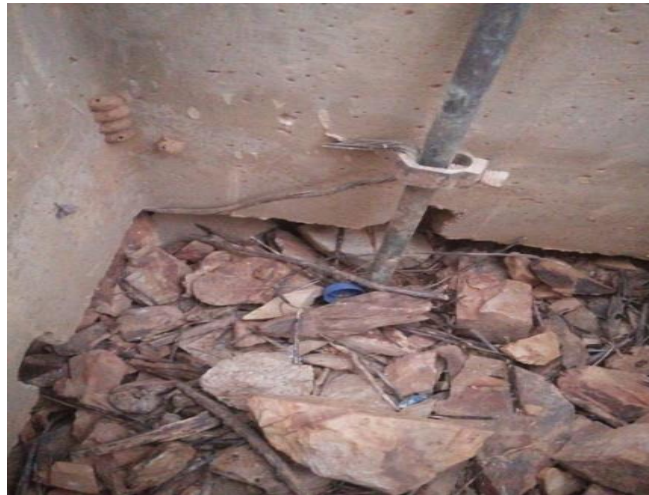
Figura 9: Puesta a tierra en mal estado.
