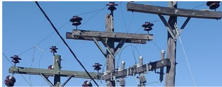
Figura 5: Crucetas de madera deterioradas.
