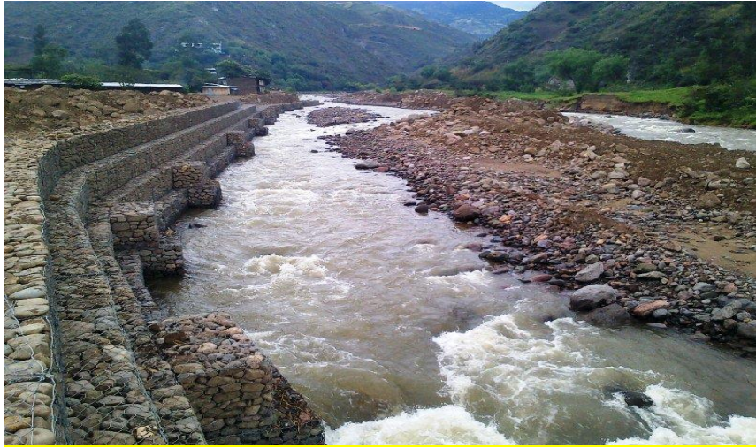
Fig. 1 Defensa Ribereña con gaviones
