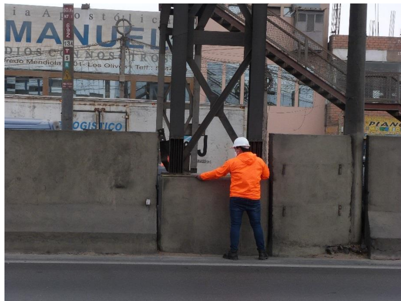
Figura 20. Medición del ancho de pilar central del puente frente a la UCV.
