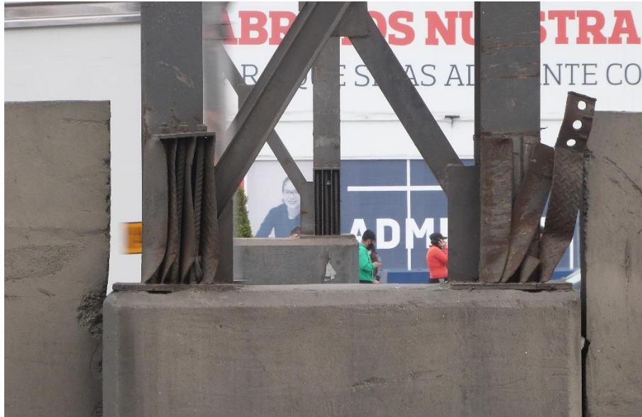
Figura 21. Daños producidos en el pilar central por impacto de los vehículos.
