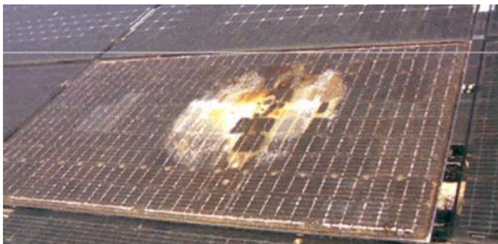
Figura 6 Incendio provocado por puntos calientes en módulo fotovoltaico. Fuente: Alonso Lorenzo, 2019.
