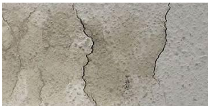
Figura 3: Fallas por contracción plástica del hormigón.
