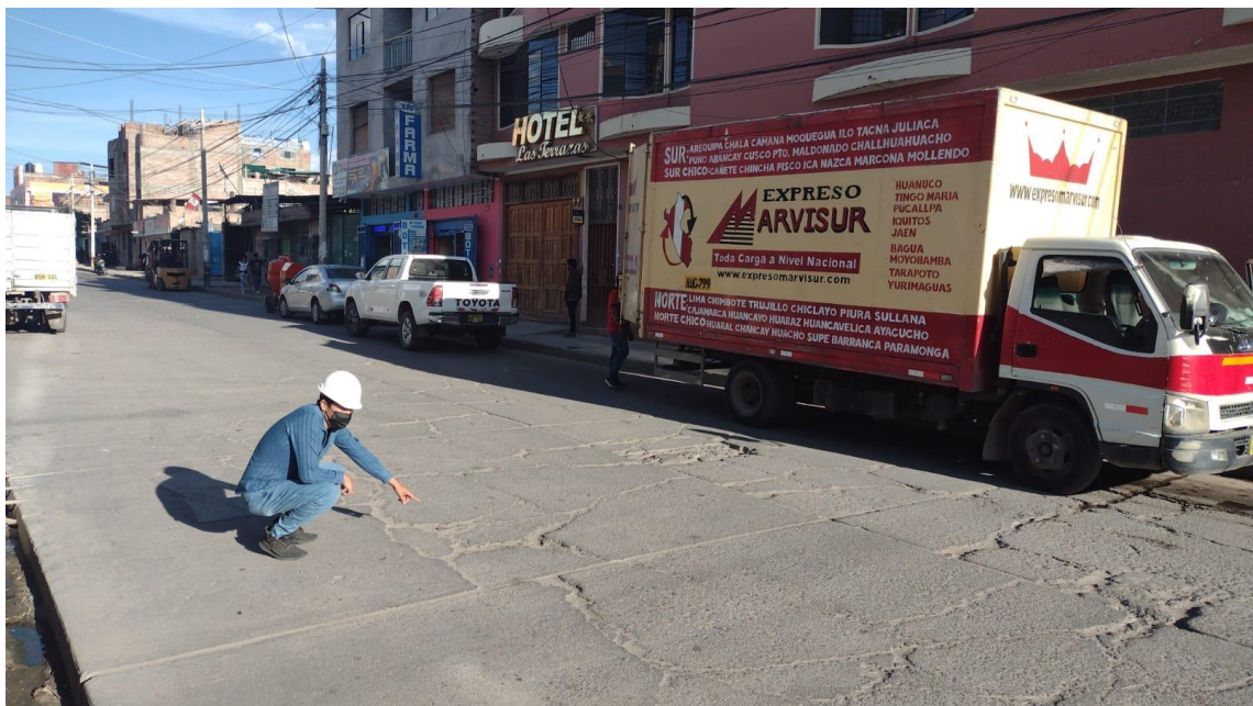
Imagen N° 0 2 Vista de la Evaluación del Pavimento de la Av. Arenales (Losa deteriorado por perdida a Flexión).
