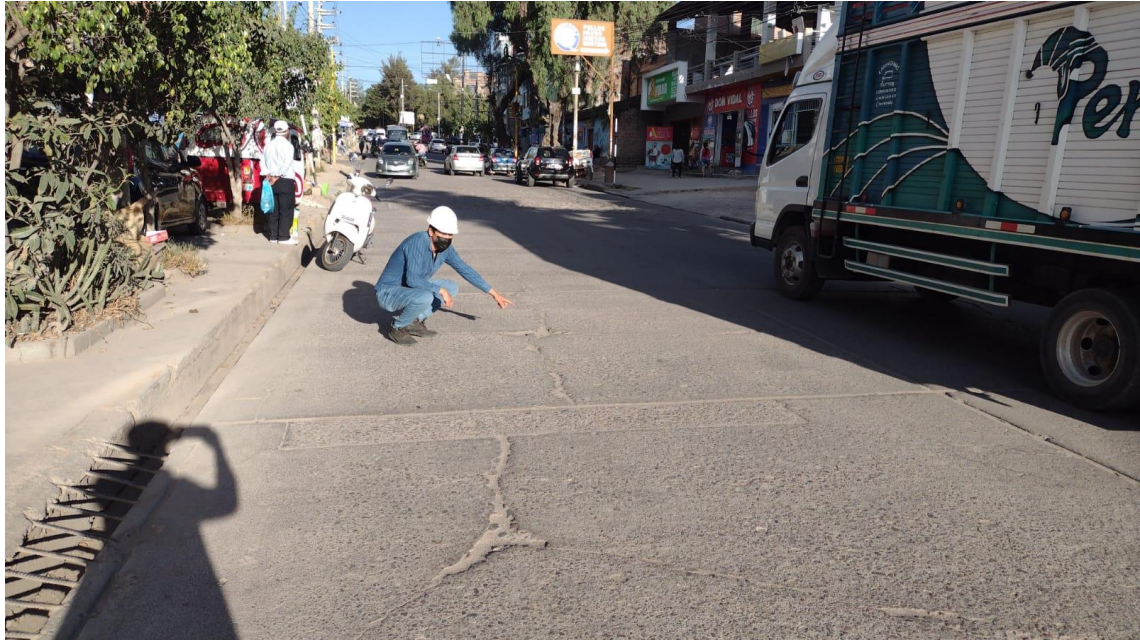
Imagen N° 0 1 Vista de la Evaluación del Pavimento de la Av. Mariscal Castilla (Losa deteriorada por perdida a Flexión).
