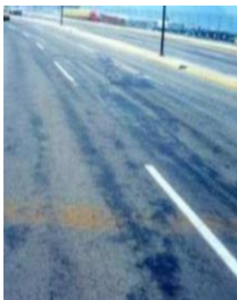
Figura 5. Efecto de exudación del asfalto
