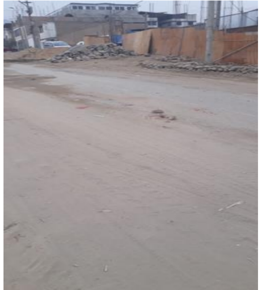
Figura 2. Fallas del pavimento
