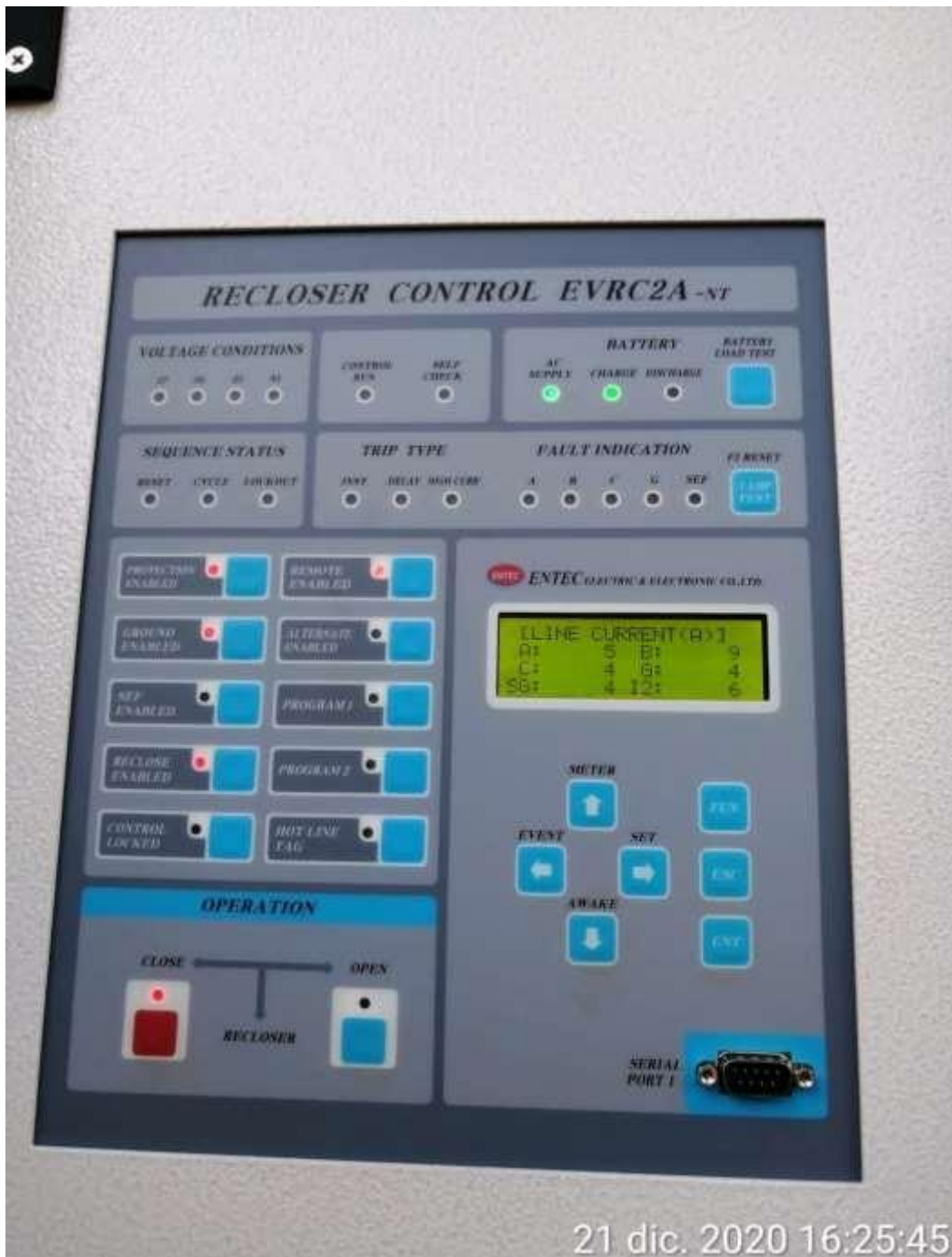
Imagen 15:Lógica de control del tablero de mando de un reconectador.
