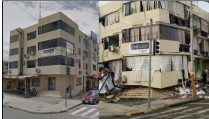
Figura 5. Colapso debido a Piso Débil Páez (2017)
