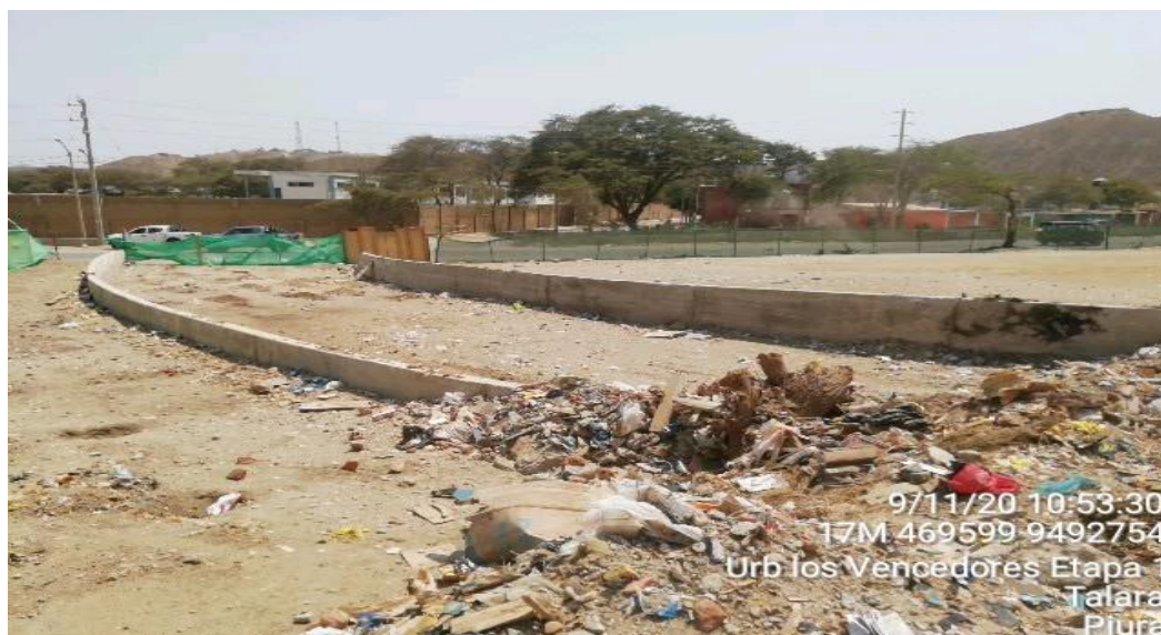
Figura 15: Evidencia de Residuos Sólidos Urb. Los Vencedores
