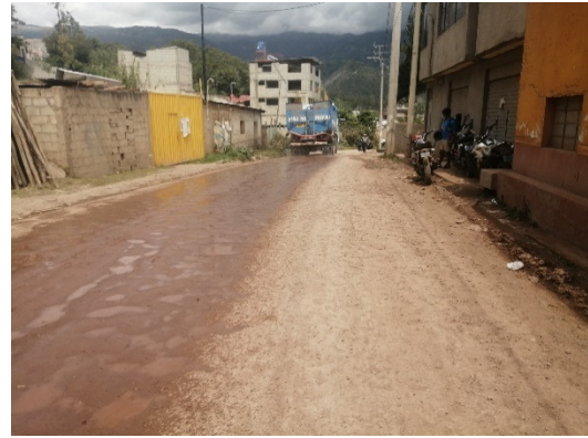
Figura 47. Evidencia del regado continuo con agua la vía de evitamiento para evitar la contaminación por exceso de polvo
