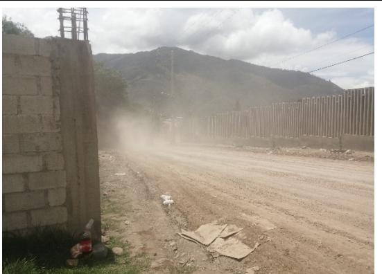
Figura 45. Evidencia del estado actual de la vía de evitamiento con exceso de polvo.
