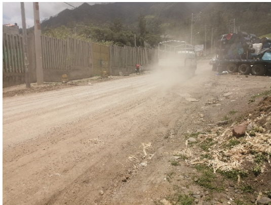
Figura 46. Estado actual de la vía de evitamiento exceso
