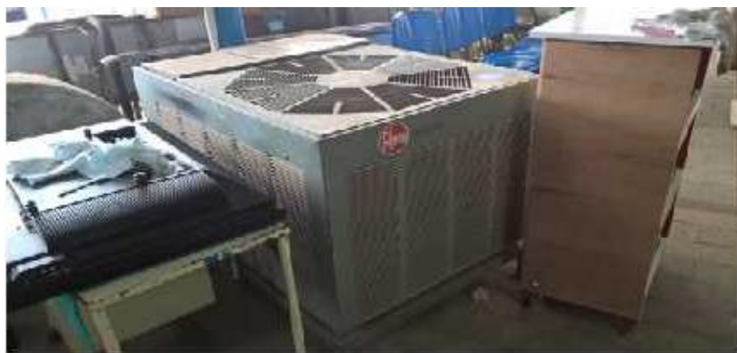
Equipo de aire acondicionado encerrado con material en desuso
