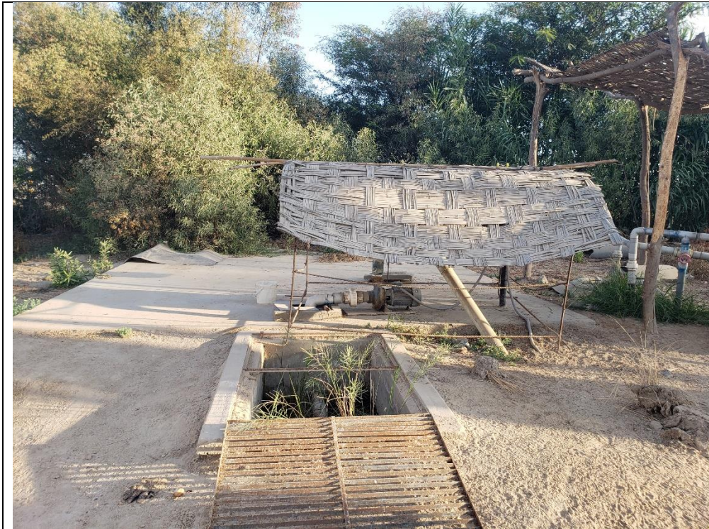
Cisterna enterrada con su equipo de bombeo, actualmente la Juntas administradoras de servicios de saneamiento (JASS) es quien les brinda el servicio.
