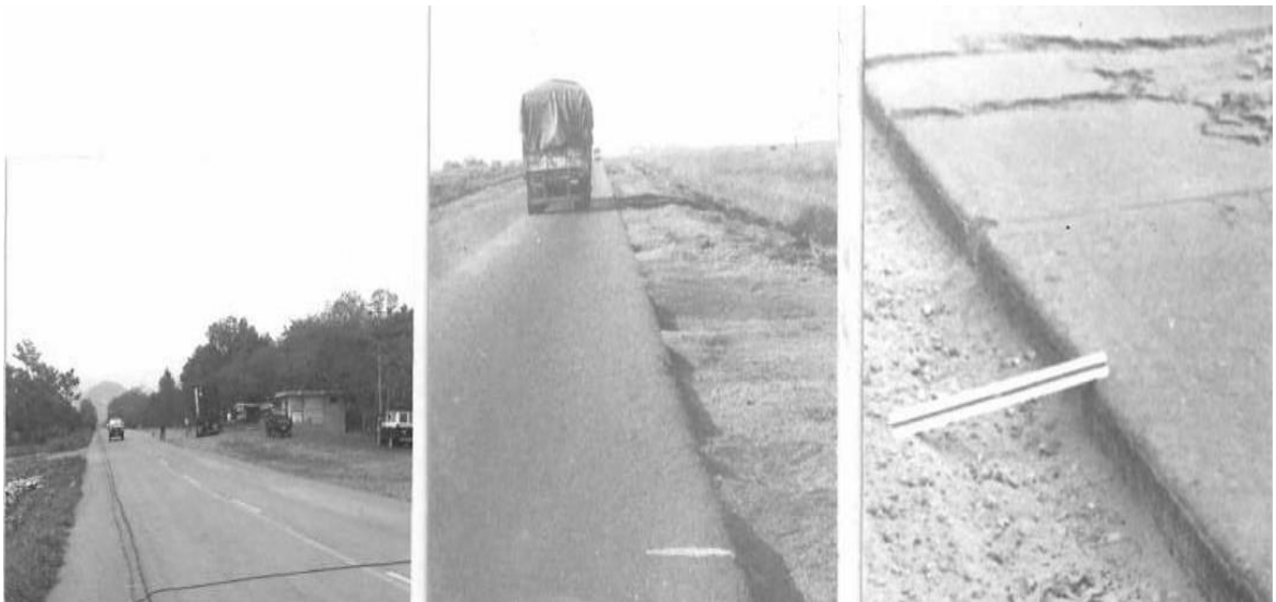
Figura 12. Desnivel de carril de severidad media y alta. Identificación de fallas en pavimentos y técnicas de reparación-Catálogo de fallas (2016)
