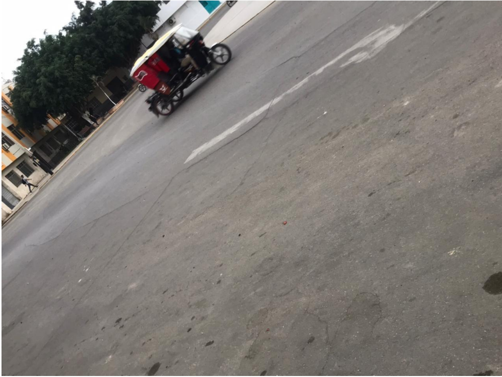
Figura 60. Agrietamiento en bloque
