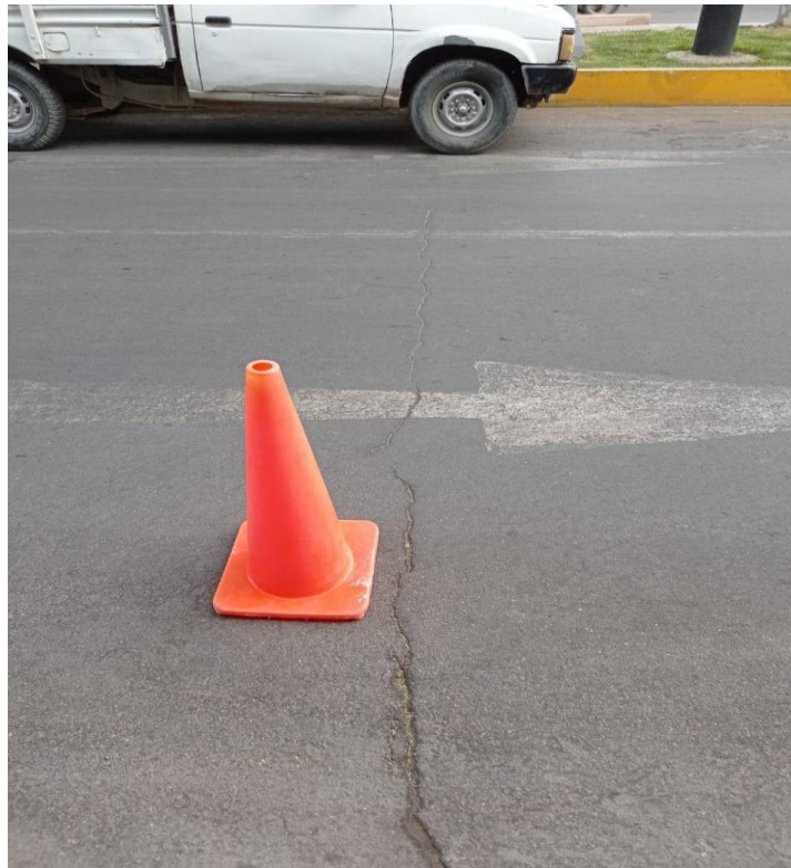
Figura 51. Grieta longitudinal y transversal
