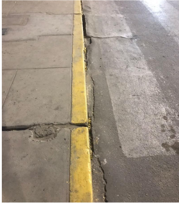
Figura 68. Grieta de borde
