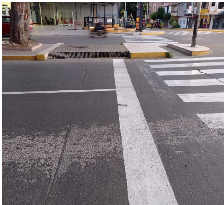
Figura 45. Desprendimiento de agregados.
