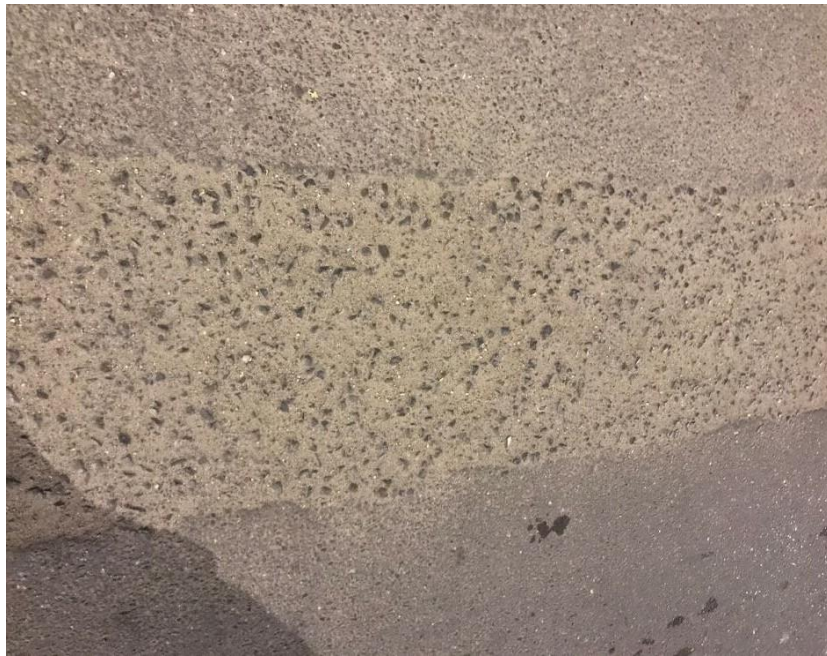
Figura 67. Desprendimiento de agregados
