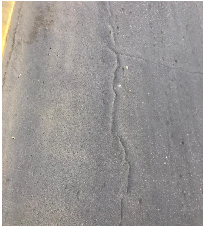
Figura 69. Grieta longitudinal y transversal
