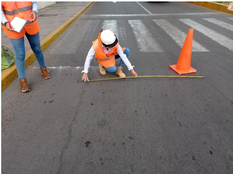
Figura 61. Agrietamiento en bloque
