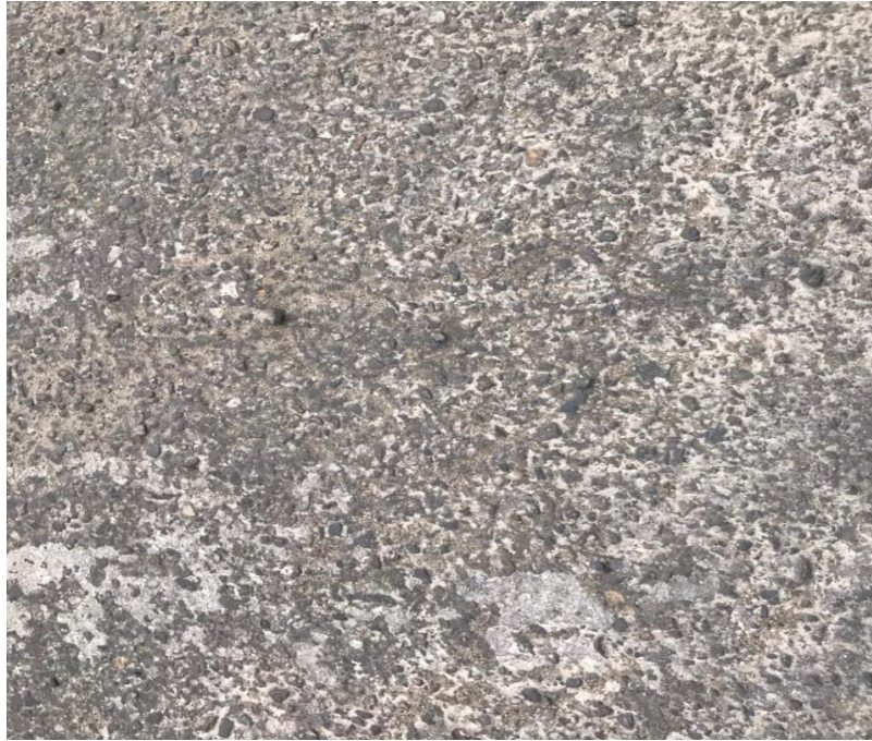
Figura 62. Desprendimiento de agregados
