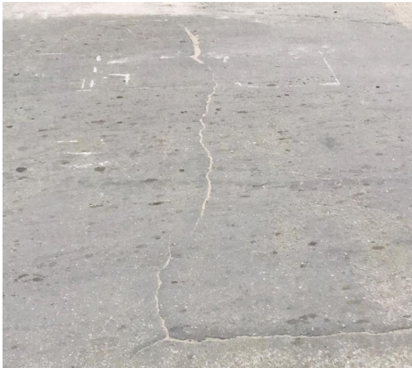
Figura 63. Agrietamiento en bloque
