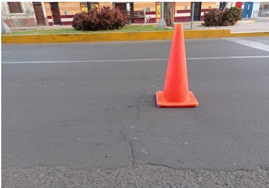
Figura 47. Grieta longitudinal y transversal-Parqueo.
