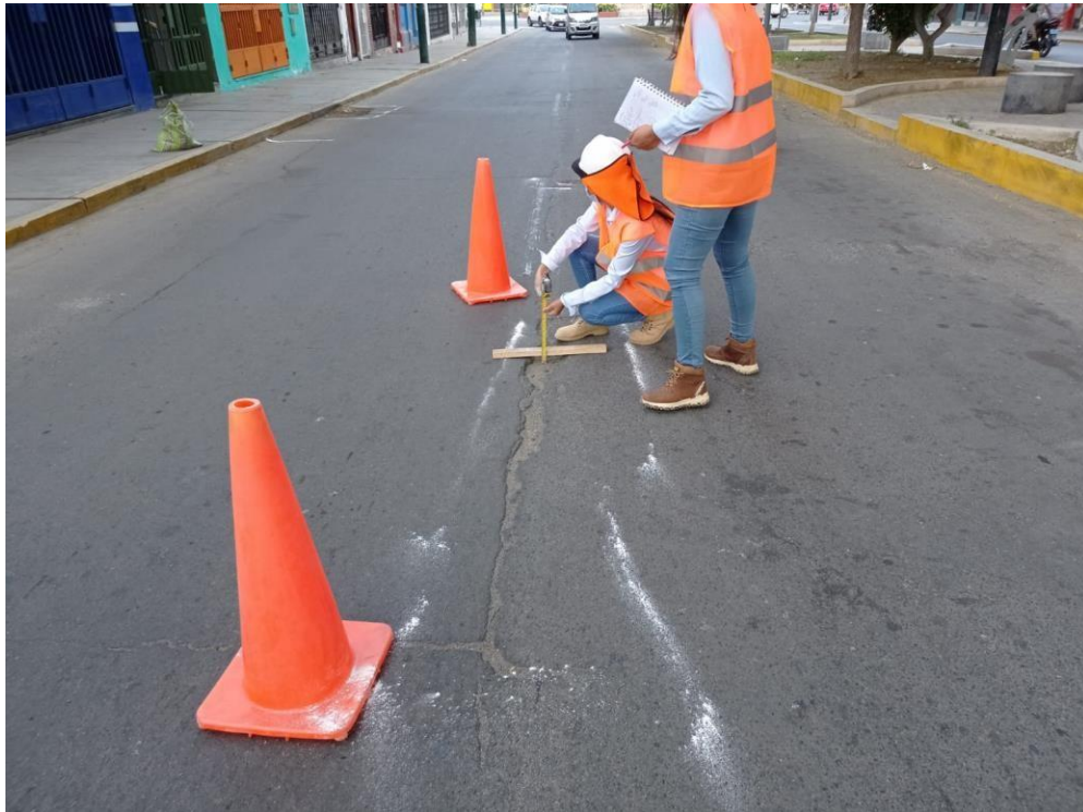
Figura 53. Grieta longitudinal y transversal
