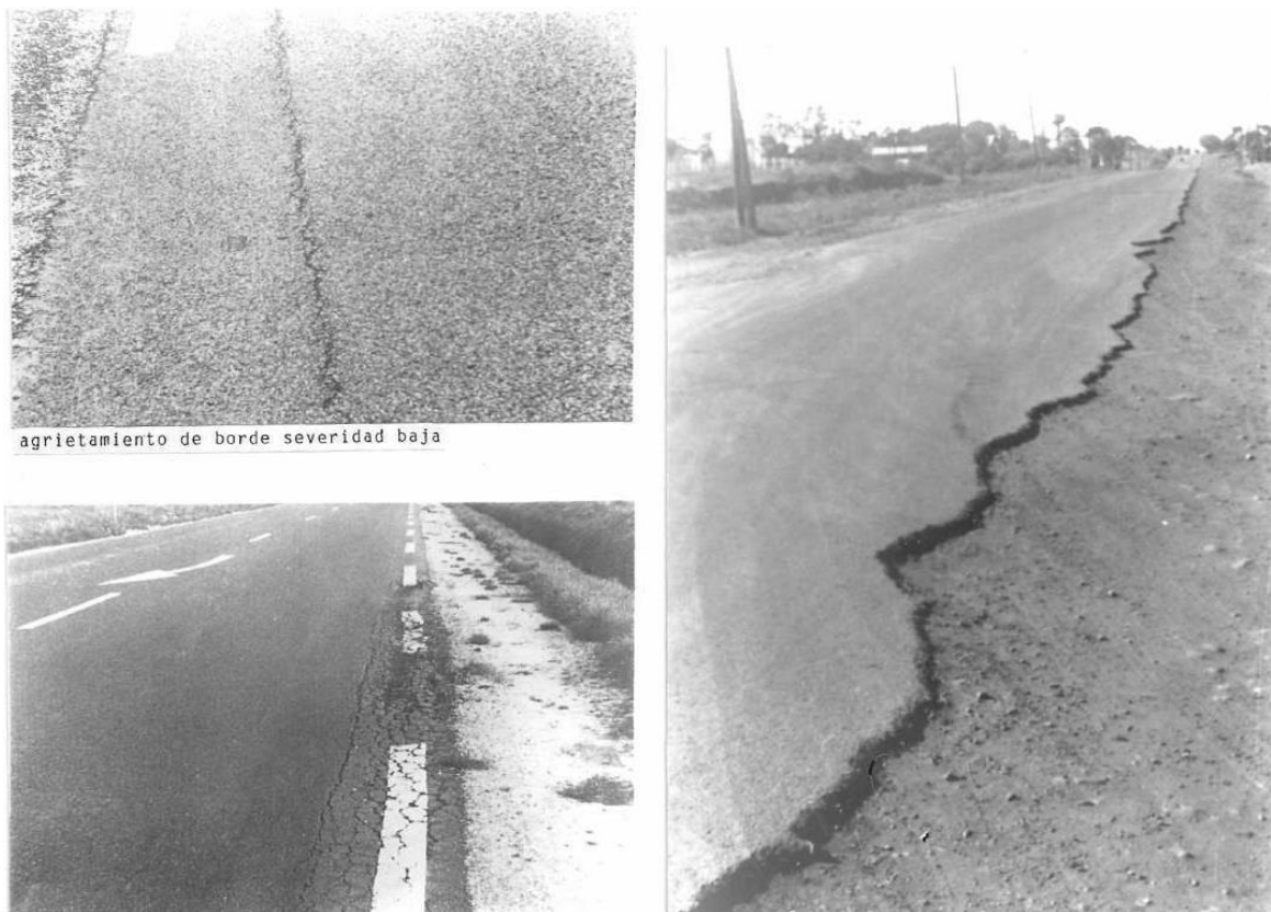
Figura 10. Agrietamiento en borde de severidad escasa, intermedia y elevada. Identificación de fallas en pavimentos y técnicas de reparación-Catálogo de fallas (2016)
