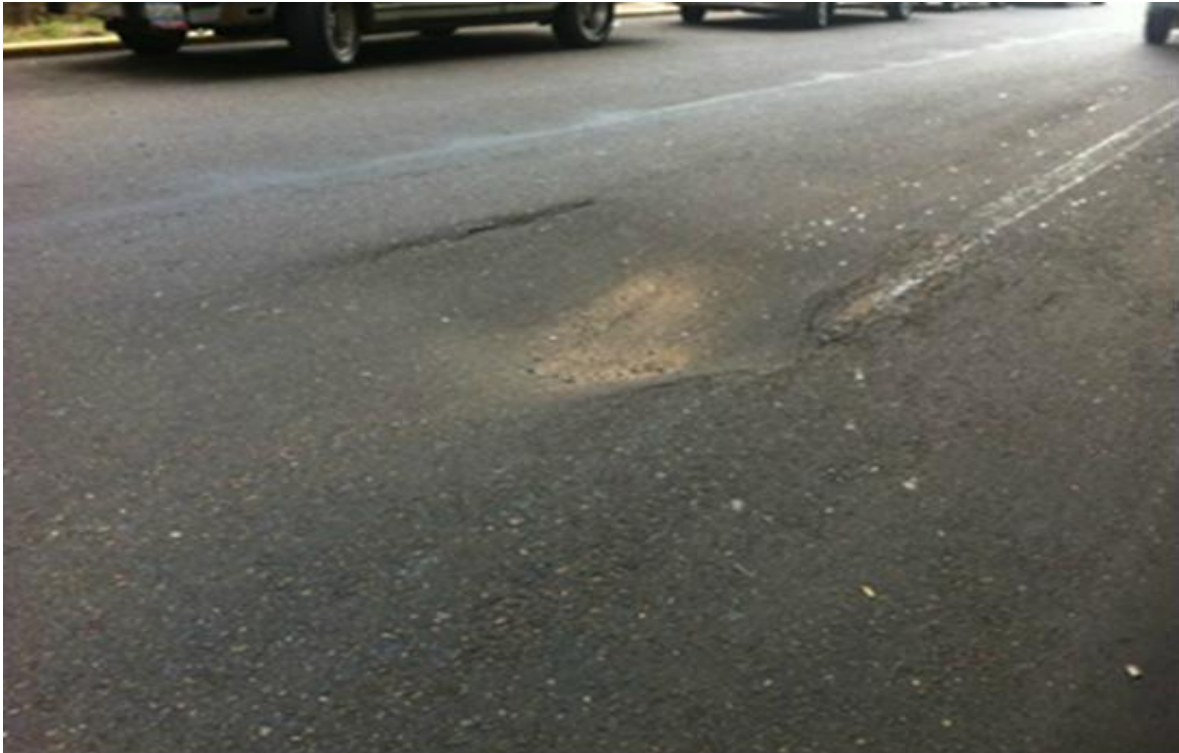
Figura 7. Deformación por hundimiento. Rodas & Ybarra (2018)
