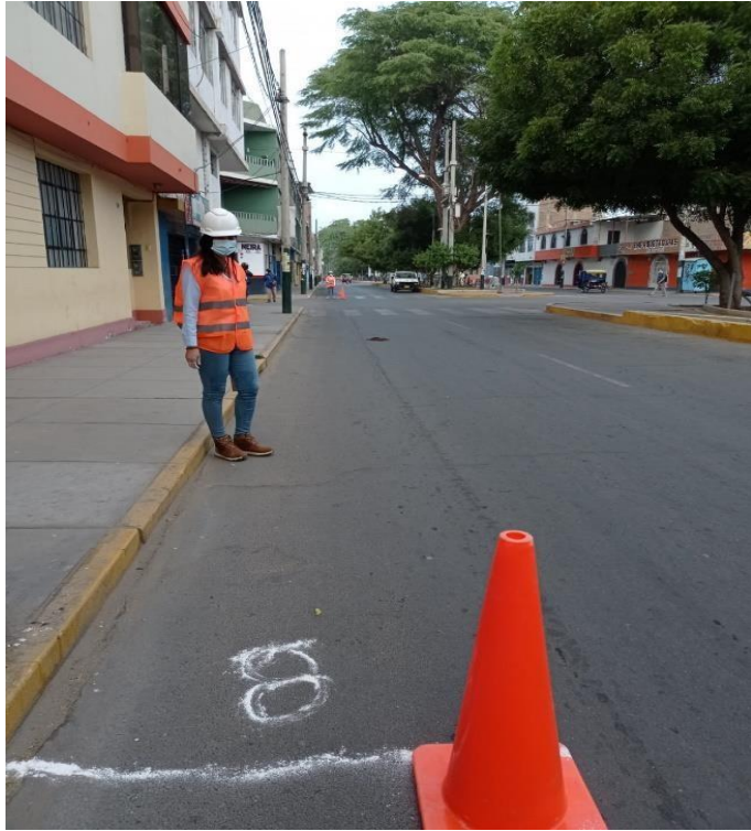
Figura 48. Grieta de borde.
