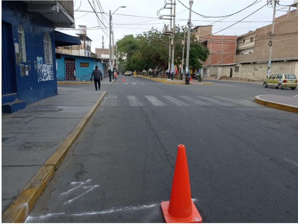
Figura 52. Desprendimiento de agregados
