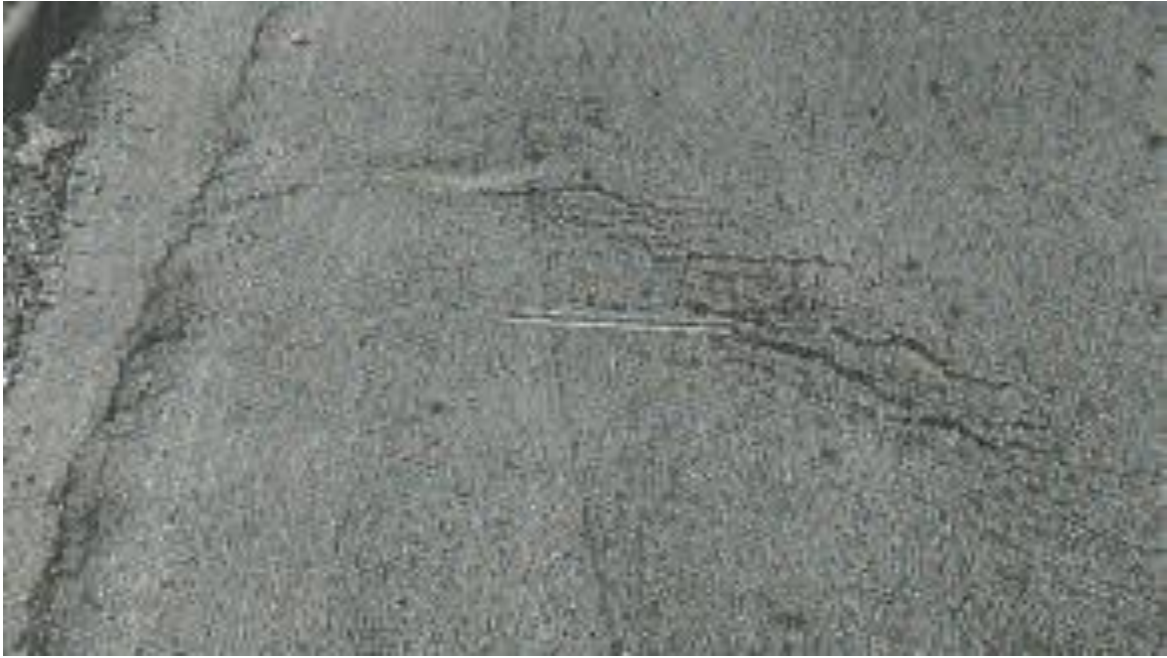
Figura 21. Grieta parabólica [Slippage] de severidad intermedia. Vázquez Varela, (2002)
