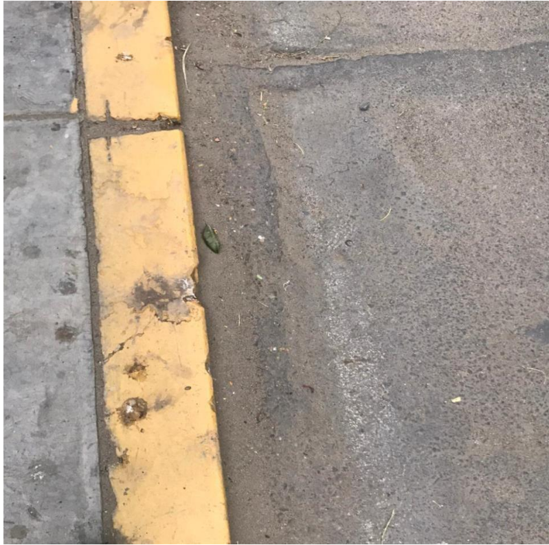
Figura 66. Grieta de borde
