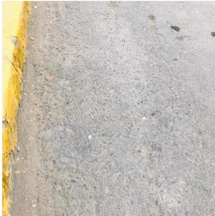
Figura 65. Desprendimiento de agregados
