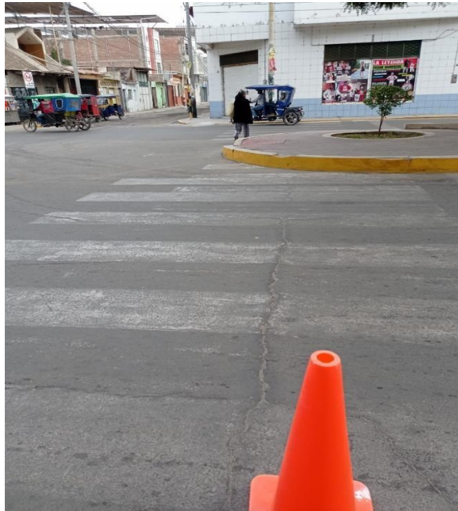
Figura 49. Grieta longitudinal y transversal.
