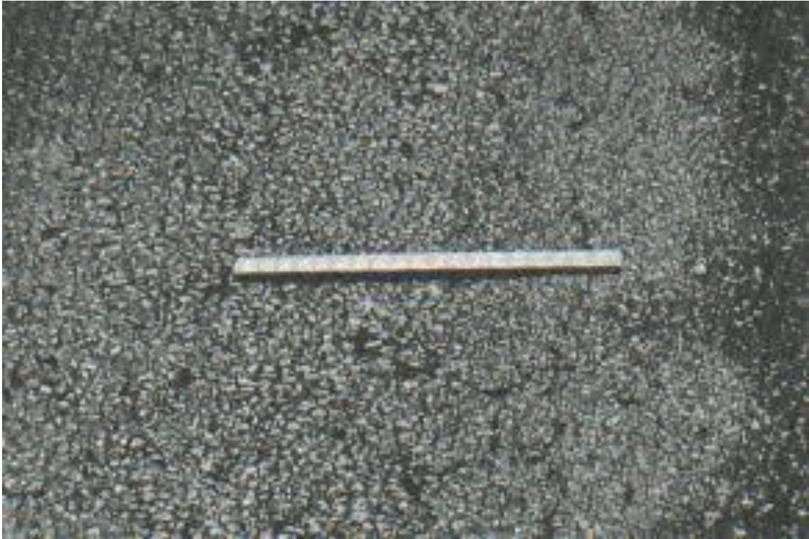
Figura 23. Meteorización/ agregados desprendidos de escasa severidad. Vásquez (2002)
