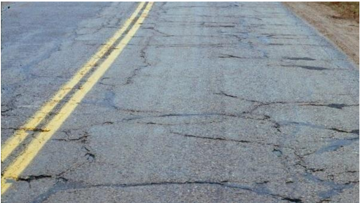
Figura 6. Grieta en Bloque. Iachini (2020)
