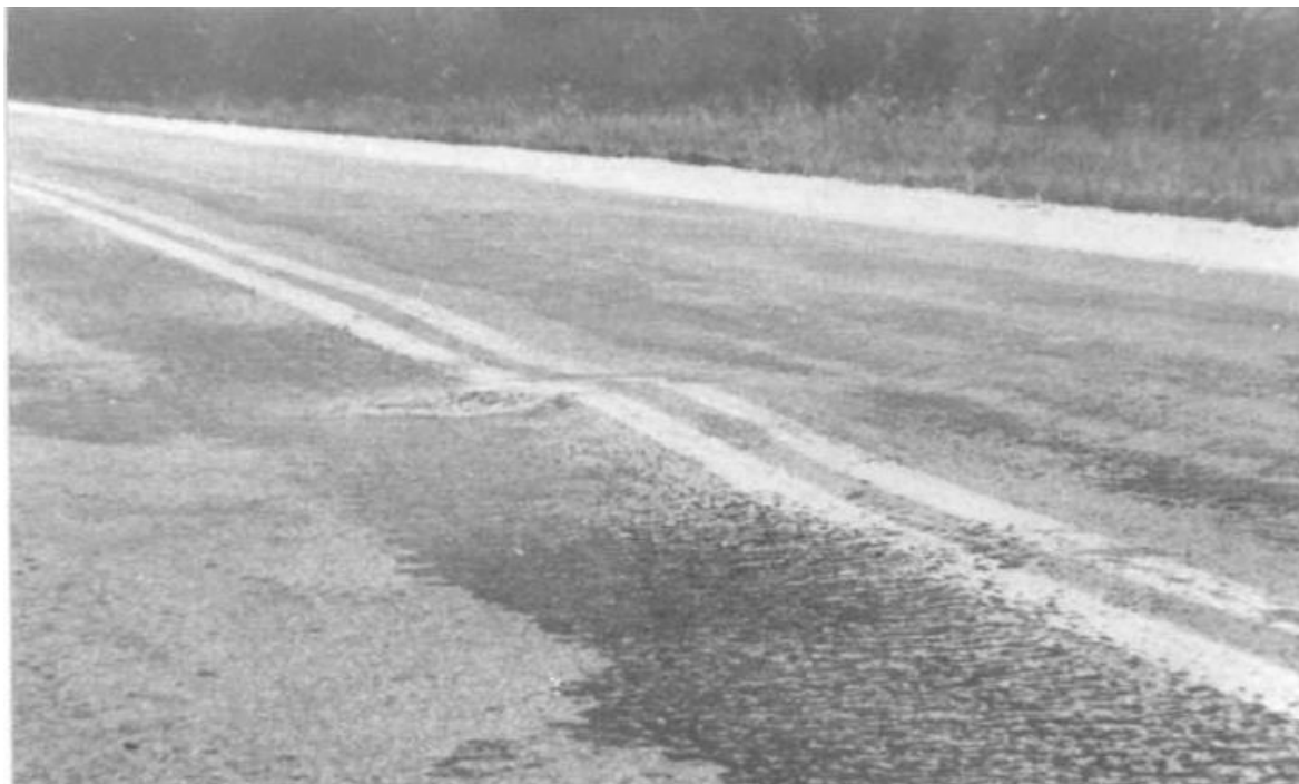
Figura 22. Hinchamiento severidad elevada. Identificación de fallas en pavimentos y técnicas de reparación- Catálogo de fallas (2016)
