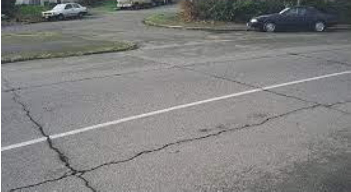
Figura 11. Grieta por reflexión de junta. Diccionario-Geotecnia.online (2021)
