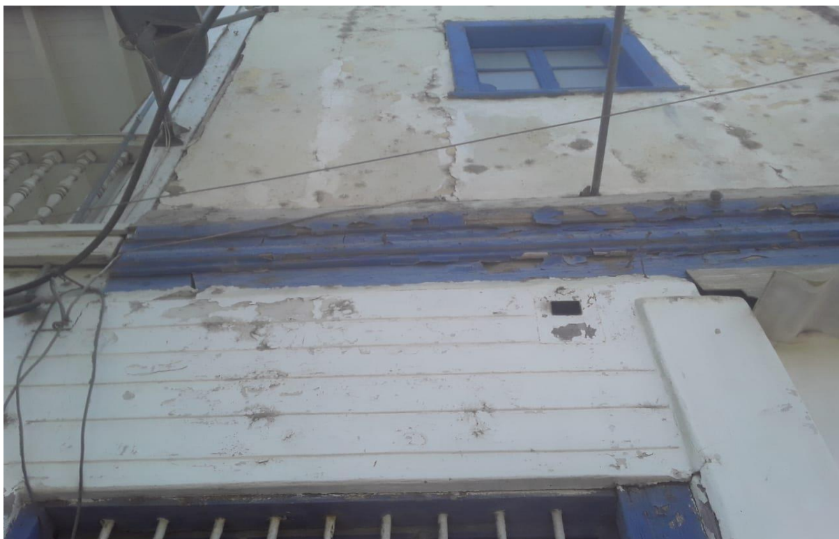
Figura 4 manchas y mohos en las viviendas
