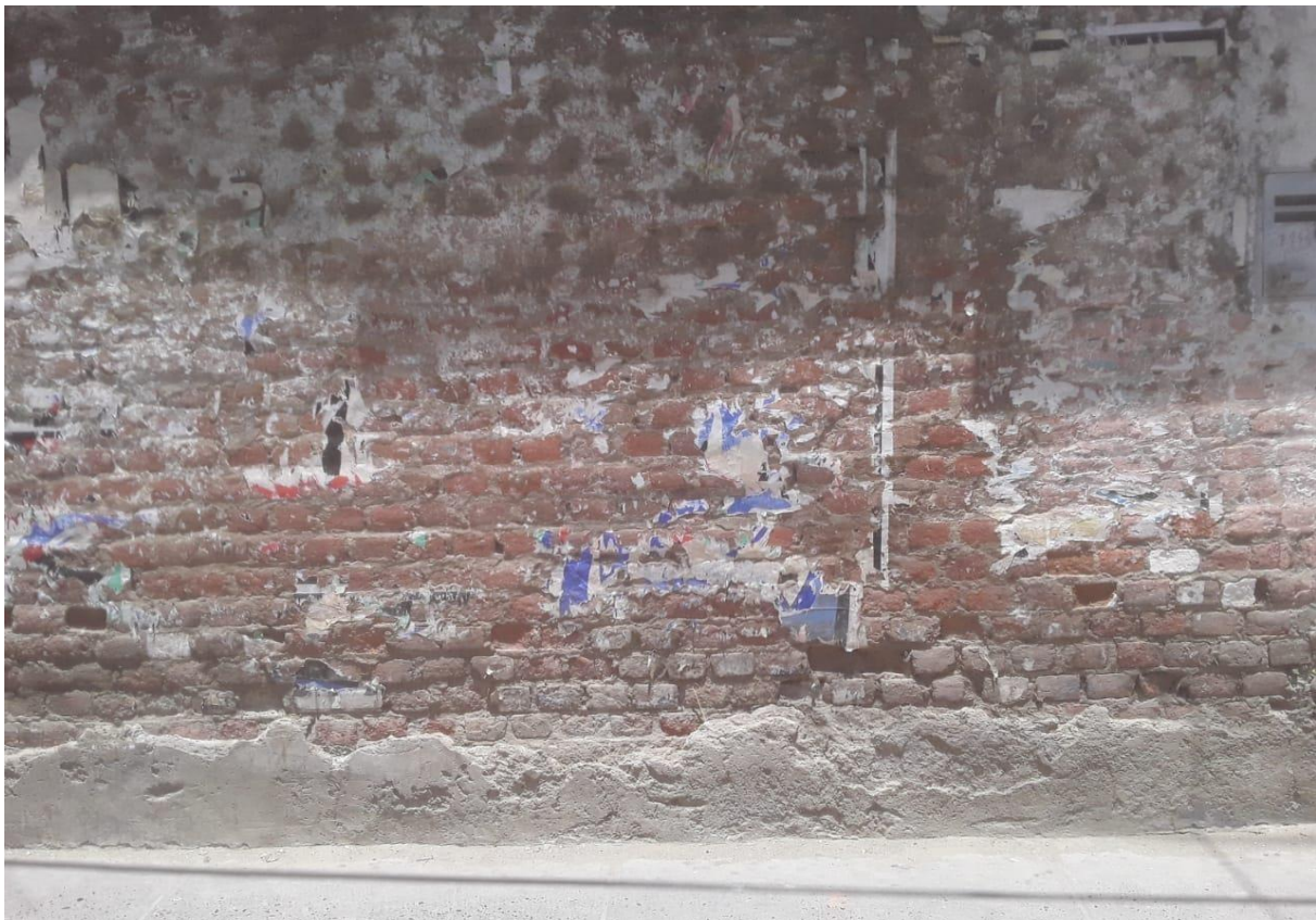
Figura 8 eflorescencias en la fachada de la vivienda
