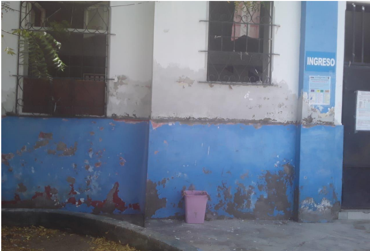
Figura 5 identificación de patologías en la fachada de la vivienda
