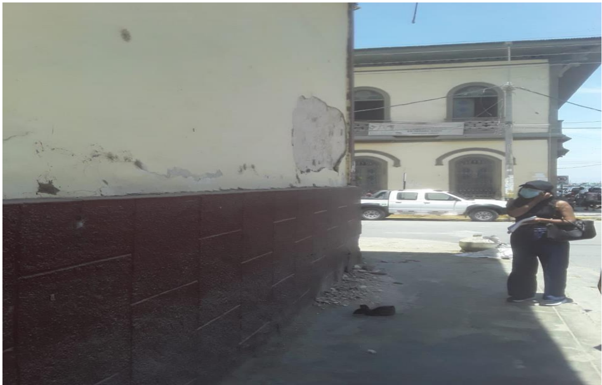
Figura 3 toma de identificación de patologías
