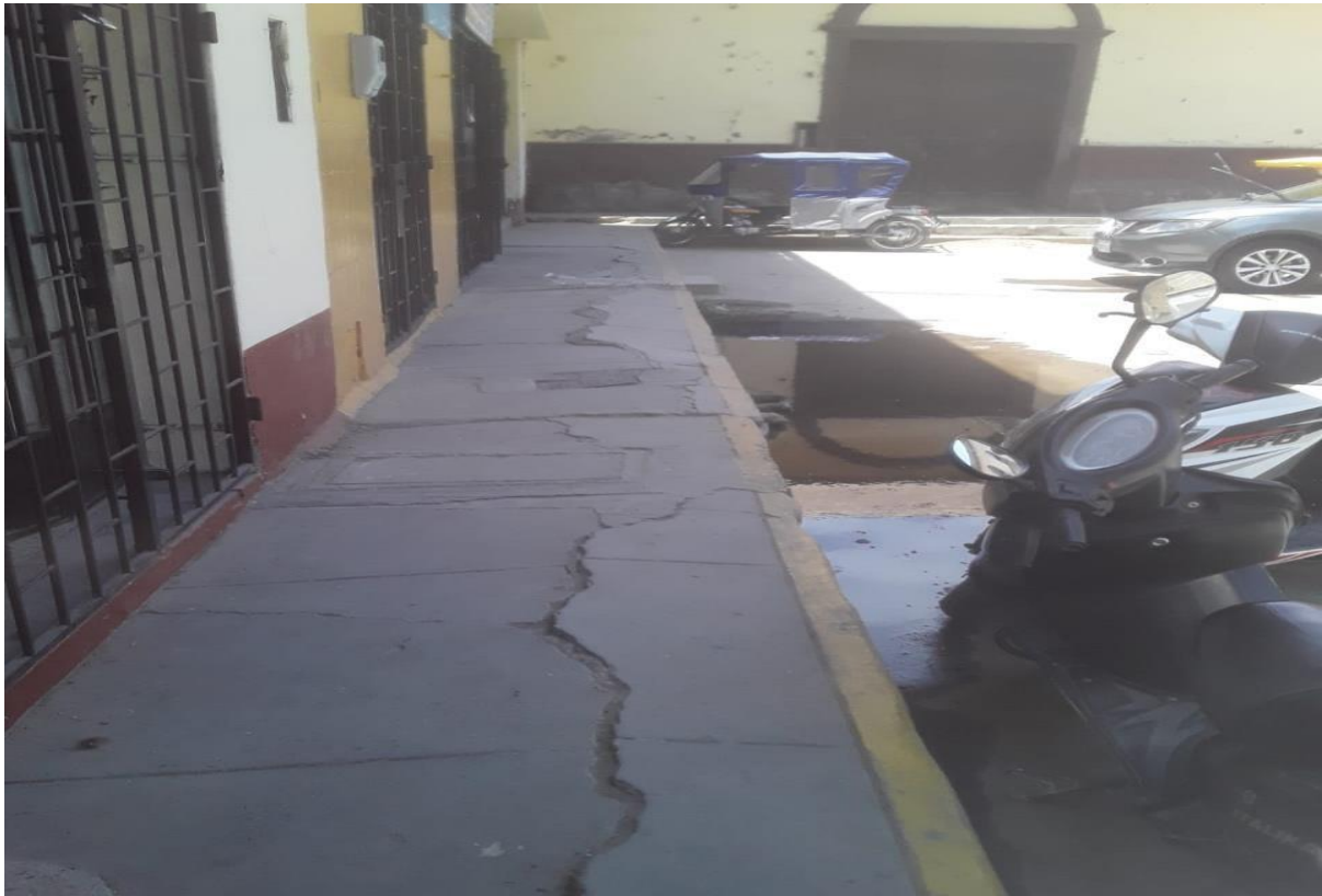
Figura 7 identificación de grietas en las veredas
