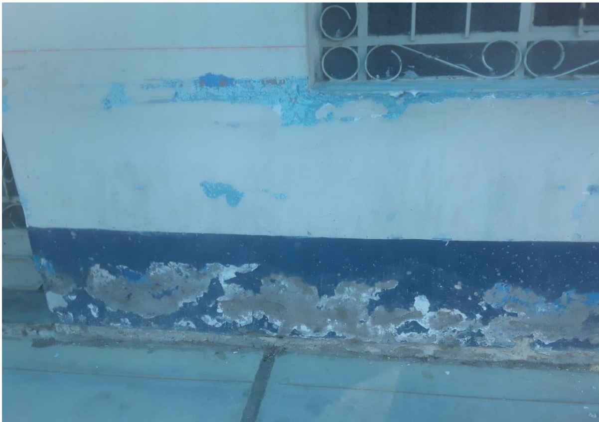
Figura 6 identificación de descascaramiento producto de la humedad
