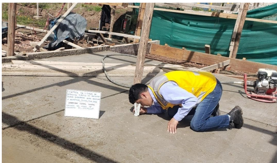
Figura 42. Visualización de fisuras mediante el empleo del microscopio visualizador de fisuras de precisión 0.025 mm.
