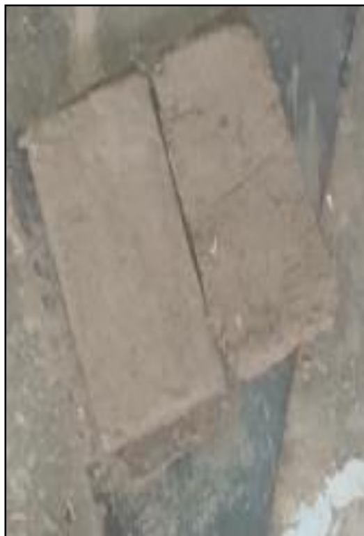
Verificación del Control de Fisuras.
