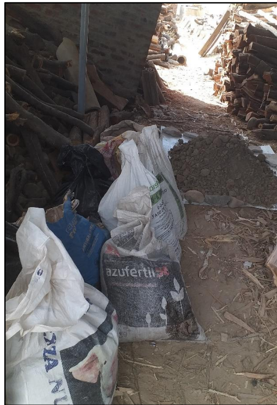
Material ya ubicado y listo para previo Triturado y Tamizado al igual que el RCD.
