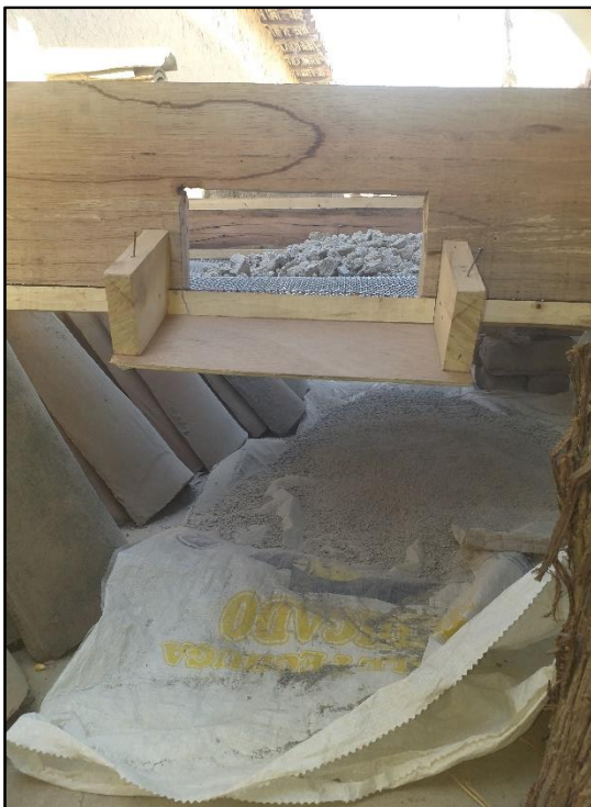
Previo tamizado se coloca unos sacos en la parte de abajo para recibir el RCD ya tamizado.
