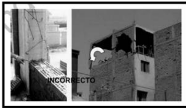
Figura 6 Proceso constructivo erróneo y su efecto
