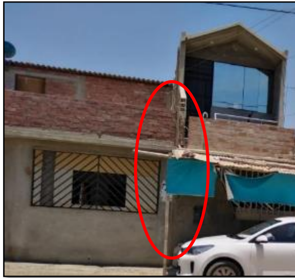
Figura 31 Insuficiencia de junta sísmica
