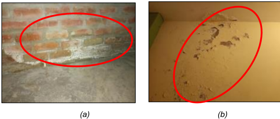
Figura 36 (a) Eflorescencia; (b) Humedad
