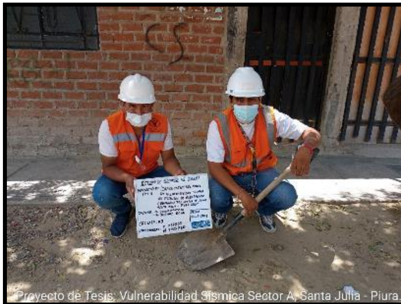
Foto N°18. Ubicación de puntos donde se realizará la exploración y toma de muestras del Estudio de Mecánica de Suelos.
