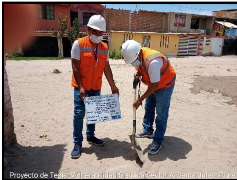
Foto N°20. Ubicación de puntos donde se realizará la exploración y toma de muestras del Estudio de Mecánica de Suelos.
