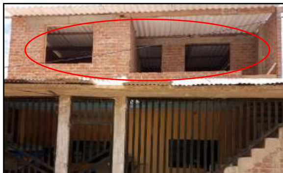
Figura 32 Tabiquería no arriostrada
