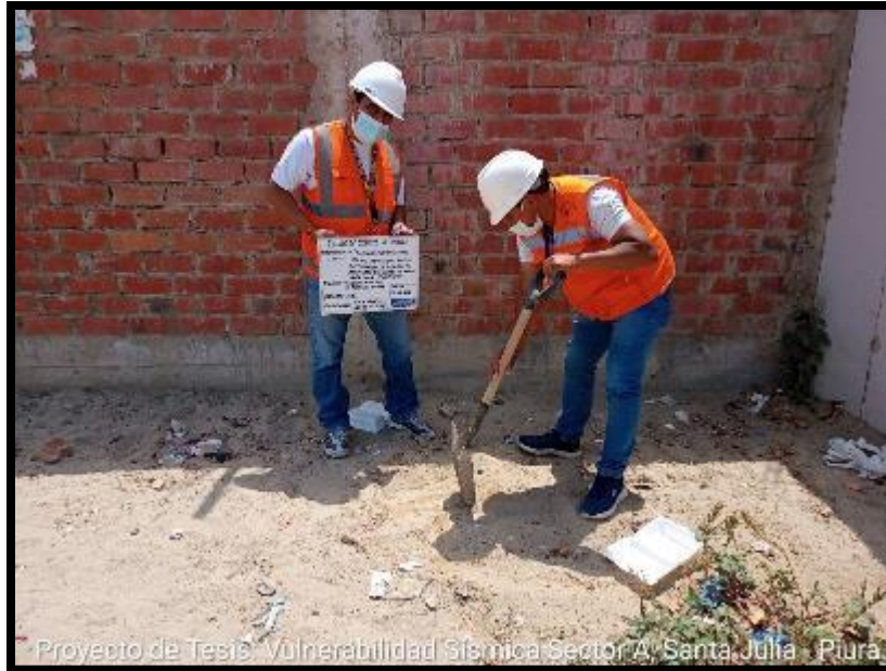
Foto N°19. Ubicación de puntos donde se realizará la exploración y toma de muestras del Estudio de Mecánica de Suelos.
