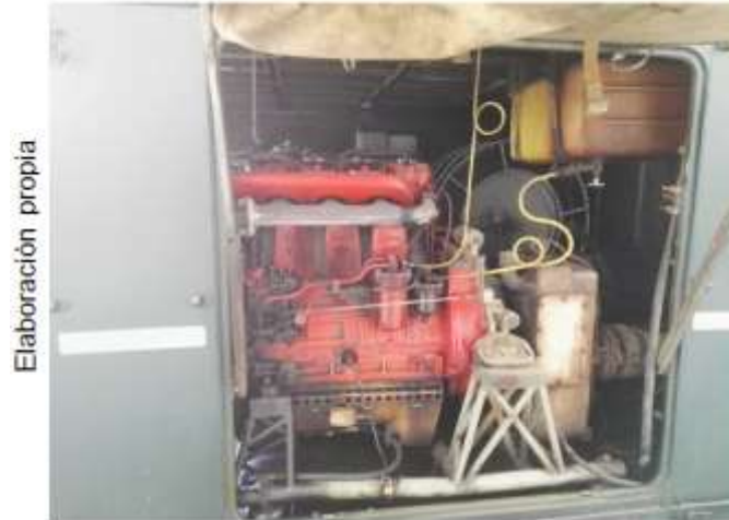
Unidad de potencia mecánica.
