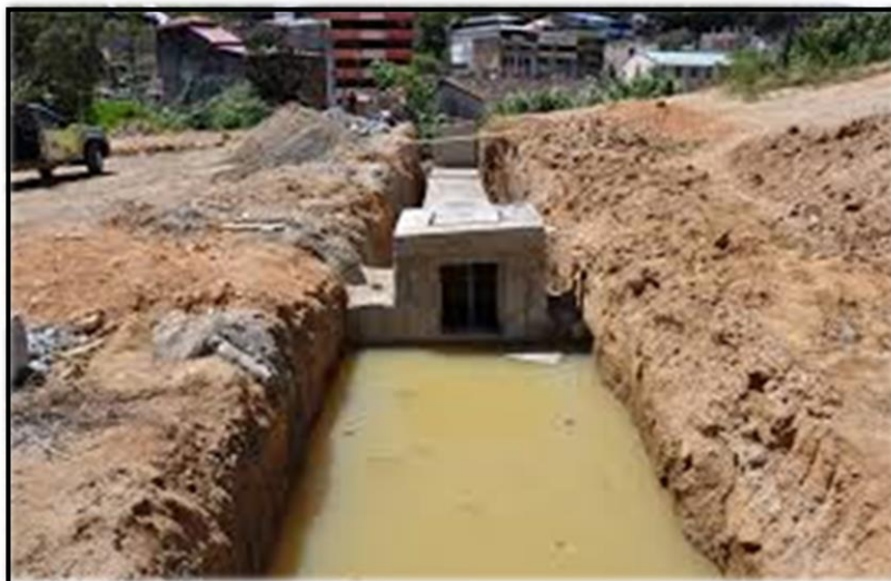
Figura N° 04 Infraestructura Hidráulica fuente Hidrologia.com
