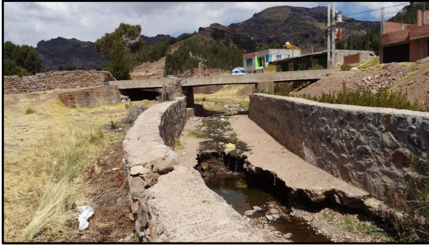
Figura N° 32 se aprecia el desgaste por erosión de la base del canal. Fuente equipo de trabajo
