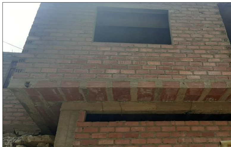
Figura 35. Falta de vigas de solera. Fuente Propia.
