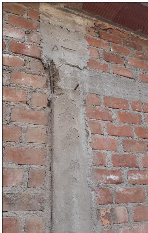
Figura 2. Fierro expuesto de una de las columnas y el no trenzado de los muros a la columna. Fuente Propia.
