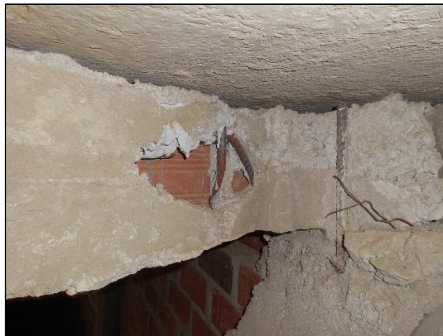
Figura 31. Acero de refuerzo de viga corroída. Fuente Propia.
