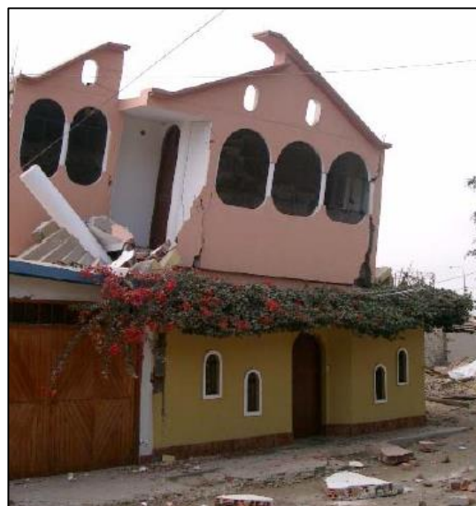
Figura 5. Vivienda de albañilería de dos pisos después de un terremoto del 2007 en Pisco. Fuente Centro Peruano de Investigación Sísmica y Mitigación de Desastre
