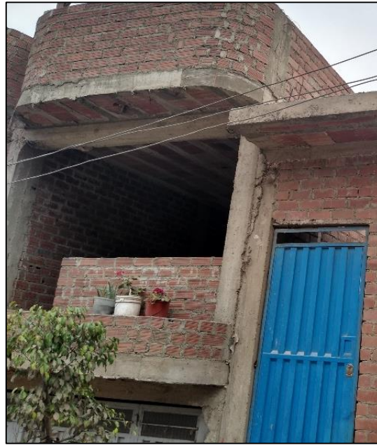
Figura 27. Insuficiencia de juntas sísmica. Fuente propia.
