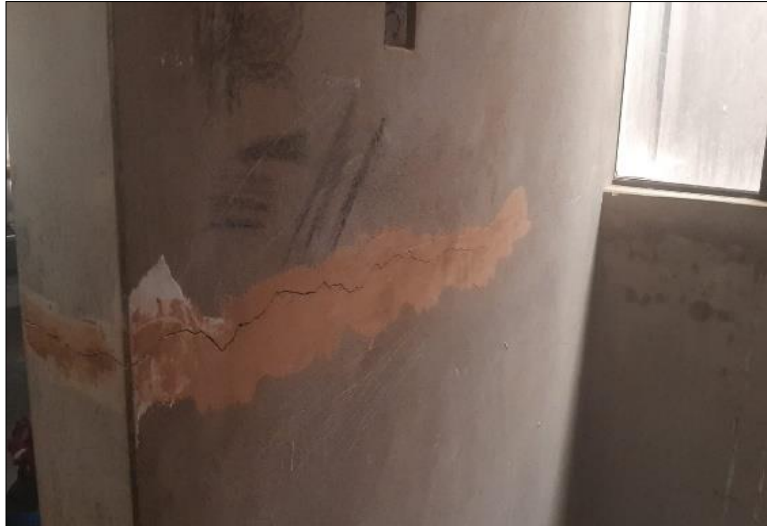
Figura 34. Muro de tabiquería agrietado horizontalmente. Fuente Propia.
