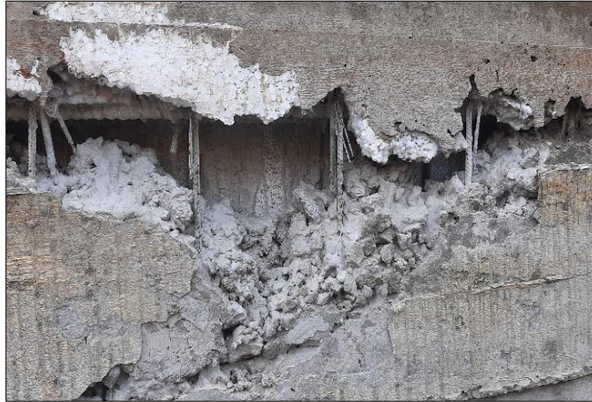
Figura 30. Cangrejera en una viga peraltada. Fuente Propia
