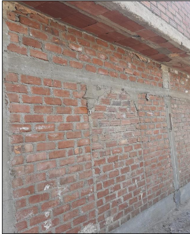
Figura 1. Proyección de puerta clausurada. Fuente propia
