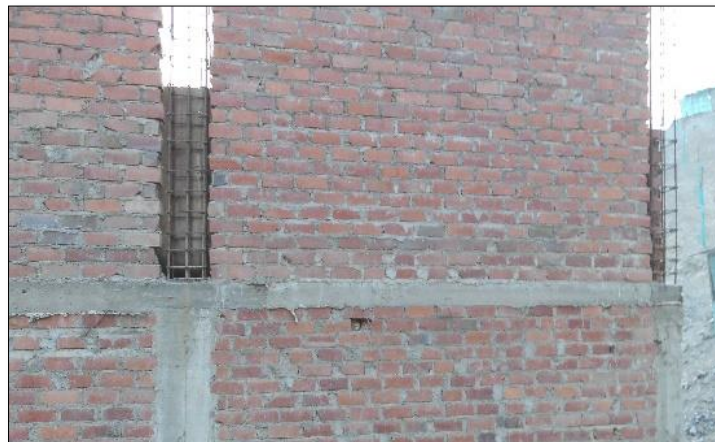
Figura 28 Tabiquería no arriostrada en el segundo piso. Fuente propia.
