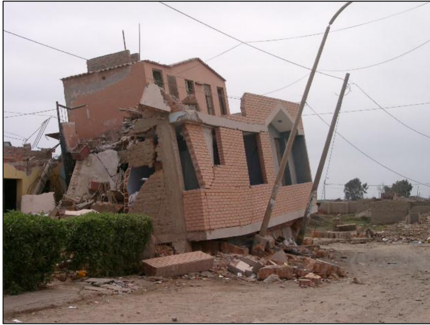
Figura 6. Muros portantes con ladrillo de pandereta después del terremoto del 2007 en Pisco. Fuente Centro Peruano de Investigación Sísmica y Mitigación de Desastre
