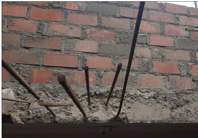
Figura 33. Acero de empalme para la escalera expuesto. Fuente Propia.
