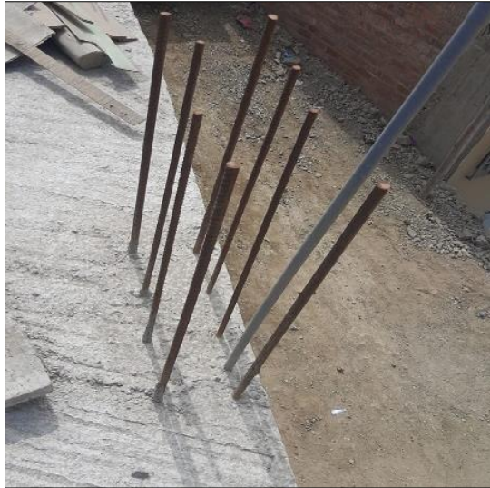
Figura 32. Acero expuesto de columnas sin ninguna protección. Fuente Propia.
