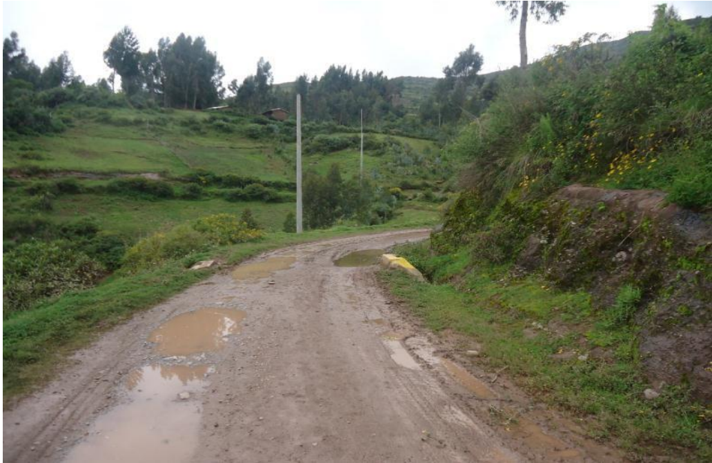
Superficie de rodadura en malas condiciones por lluvias.
