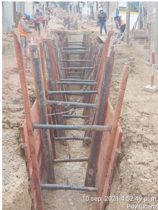
Foto 6: Falla de puntales por aplastamiento y sobrecarga.
