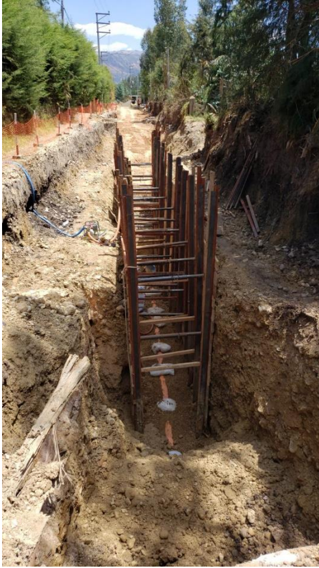
Foto 5: Detalle de sobre excavación por falla de vigas.
