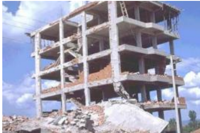
Figura 5. Estructura dañada por fallas sísmicas.
